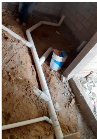
Figura 108. Instalación Sanitaria Baños Hombres. Fuente: Propia.
