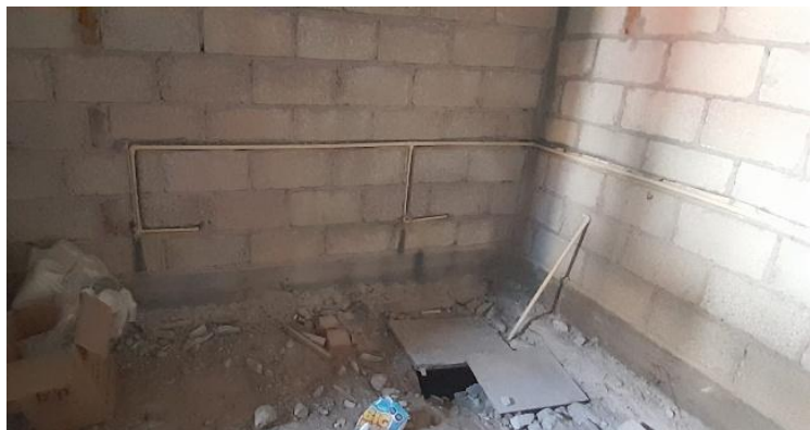
Figura 101. Instalación Hidráulica en Baño de los Hombres. Fuente: Propia.
