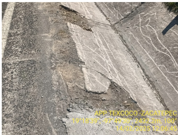
Imagen 20. Detección de obra de drenaje en mal estado. Fuente: Propia
