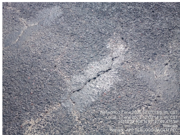
Imagen 12. Detección de una grieta transversal. Fuente: Propia.
