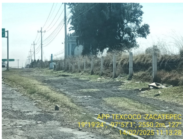
Imagen 24. Detección de incidencia de limpieza de derecho de vía. Fuente: Propia
