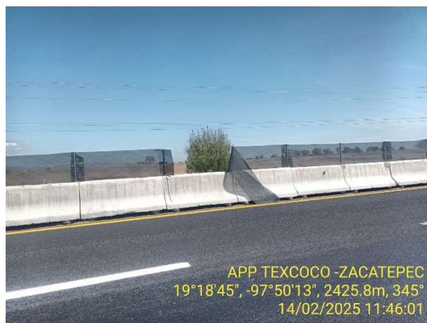
Imagen 23. Detección de malla antideslumbrante dañada. Fuente: Propia
