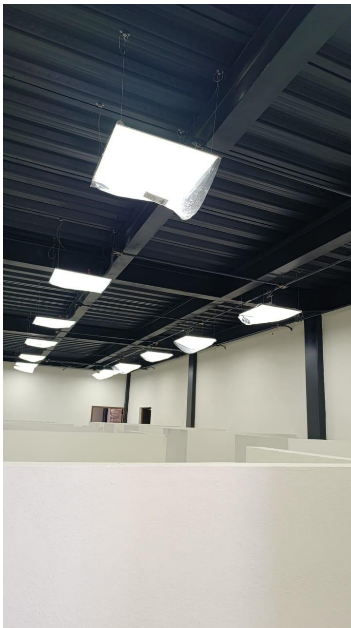
Figura 23 Luminarias instaladas en los cubículos del edificio administrativo en planta alta entre los ejes 3 y 6.
