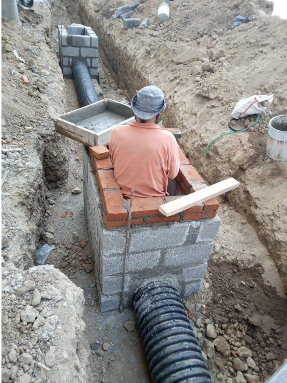
Figura 41 Registros sanitarios del pabellón A del CEDDART parte trasera del pabellón.
