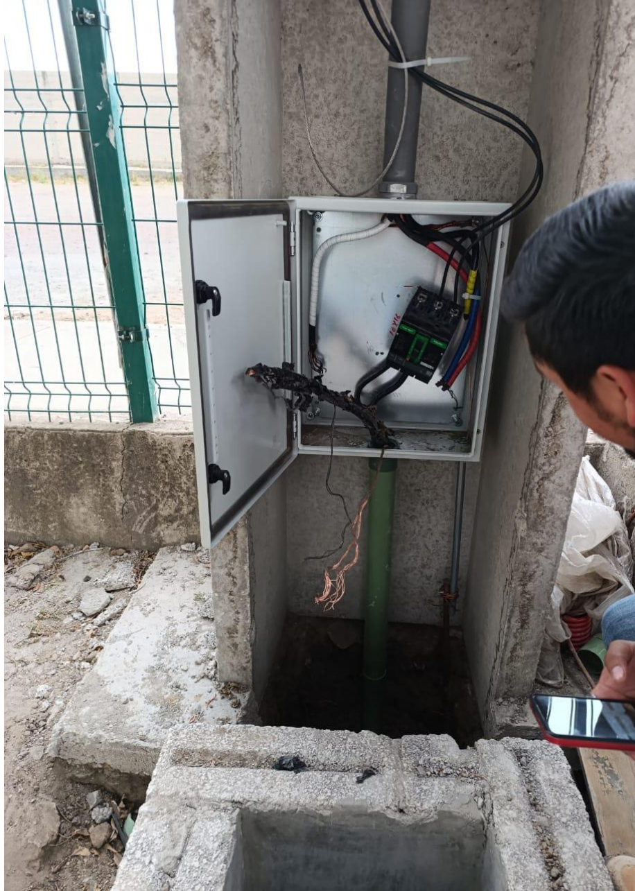
Figura 16 Acometida del edificio administrativo del CEDDART entre ejes E y F.
