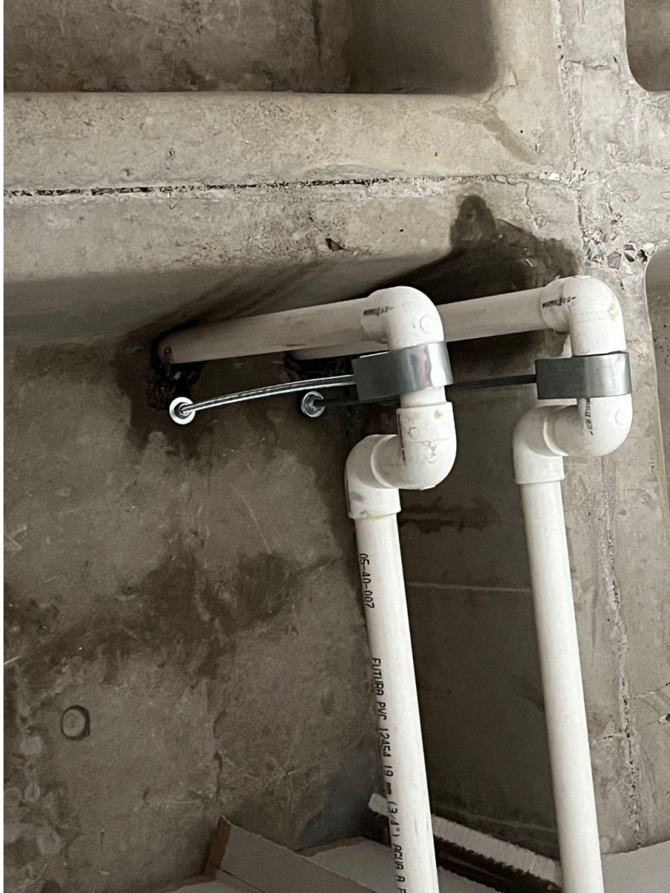
Figura 34 Tubería sanitaria en lavabo planta baja entre ejes D y E.
