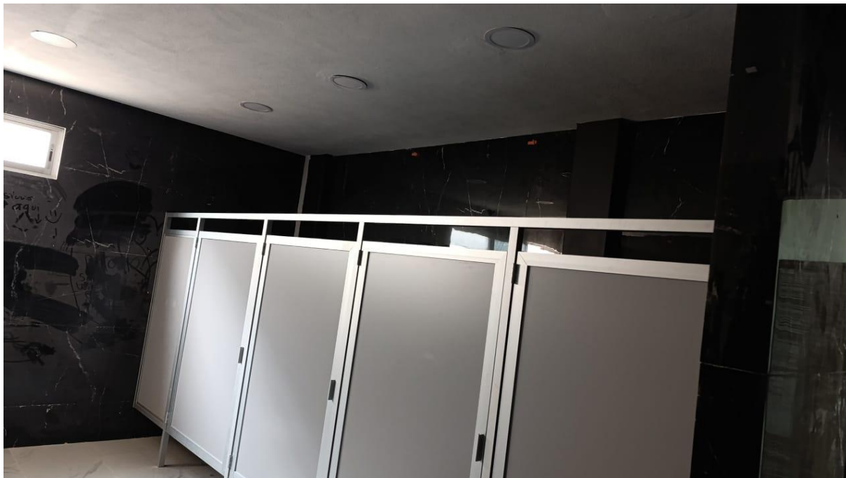
Figura 24 Luminaria empotrable bucaramanga VIII marca tecnolite en sanitarios planta alta entre ejes C y D.
