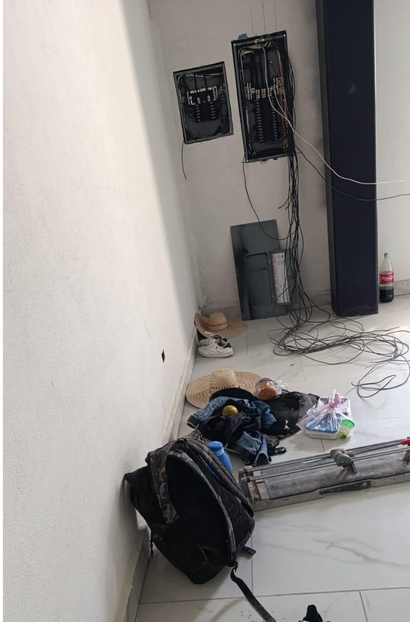
Figura 28 Tablero de carga del edificio administrativo del CEDDART planta baja entre los ejes G y H.
