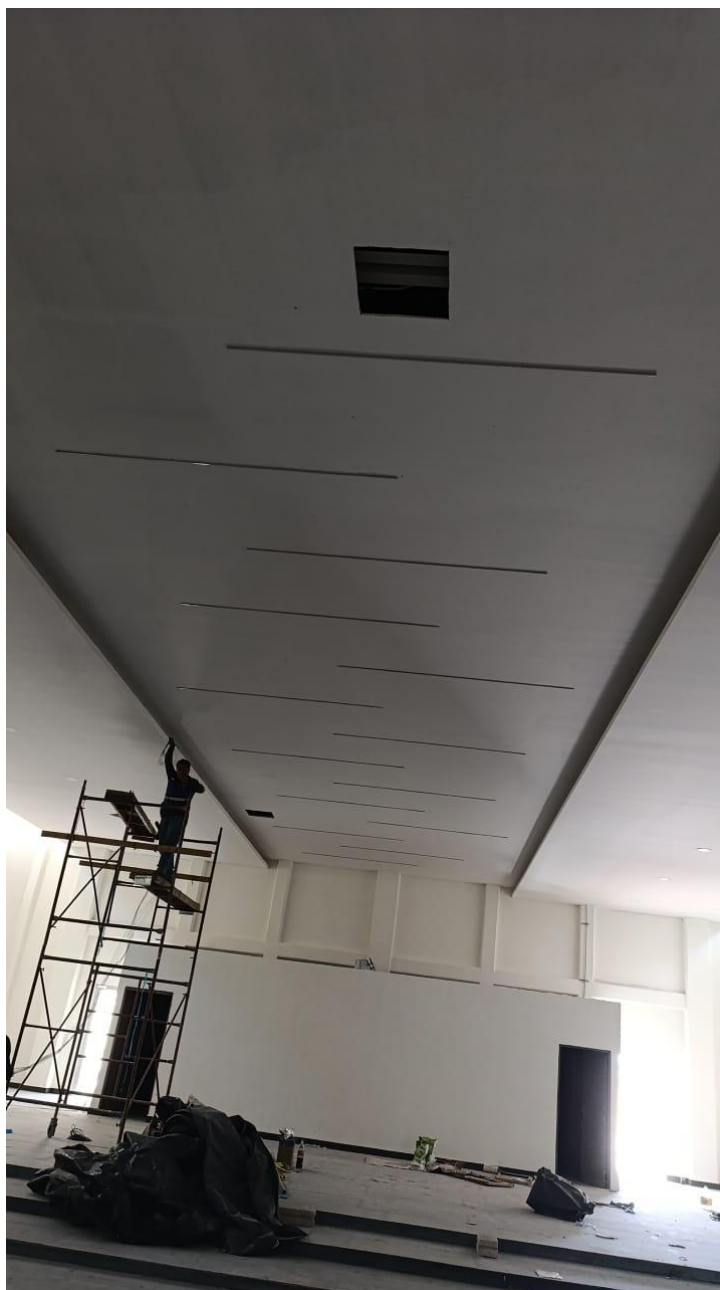
Figura 26 Tira flexible 480 leds por metro led cob blanco interior en Auditorio de CEDDART planta baja entre ejes I y J.
