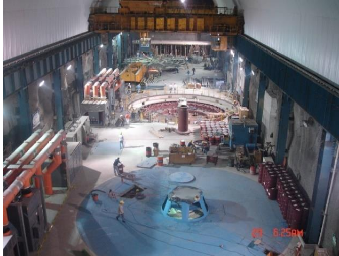
Ilustración 7. Casa de Máquinas en caverna, de la Central Hidroeléctrica La Yesca, Nayarit.
