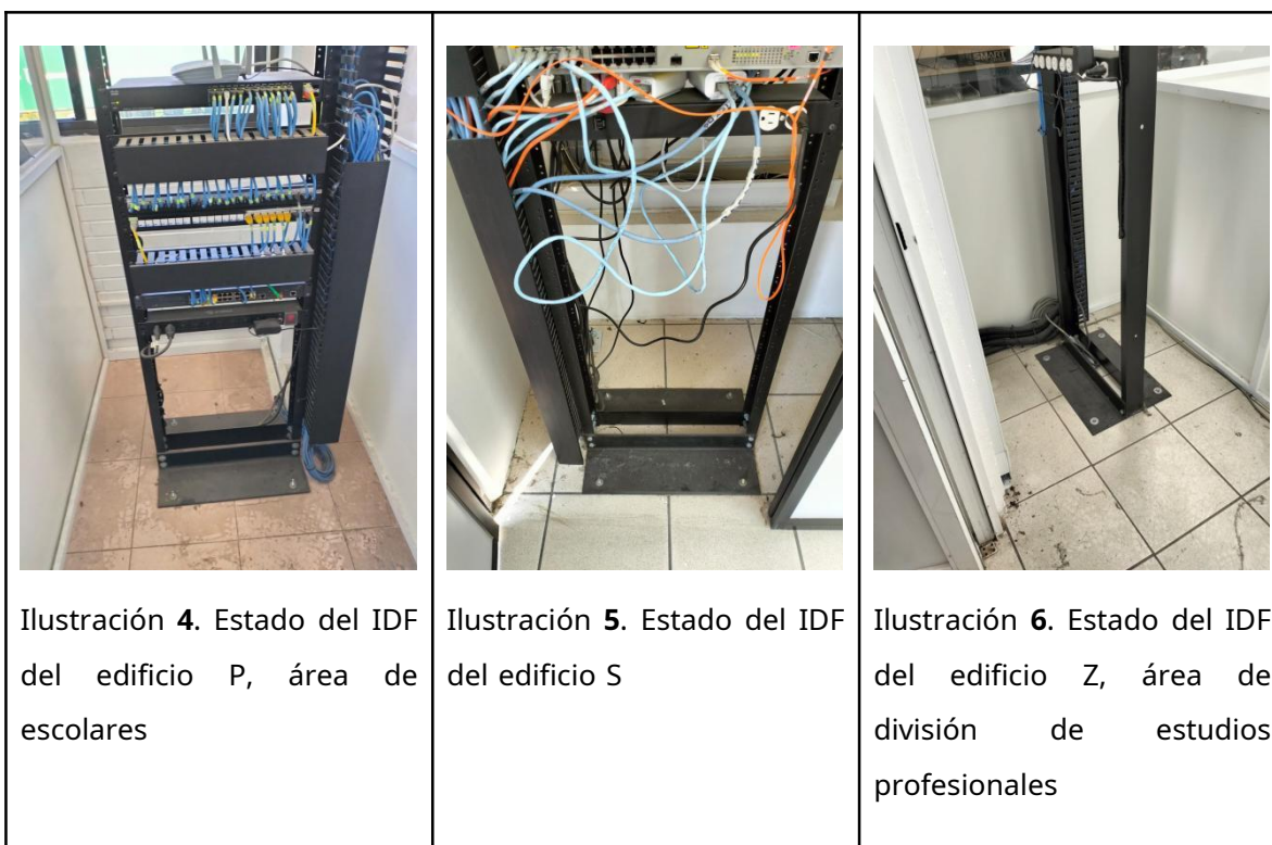
Figura 5 Evidencia del estado físico deteriorado de los racks de comunicaciones.
