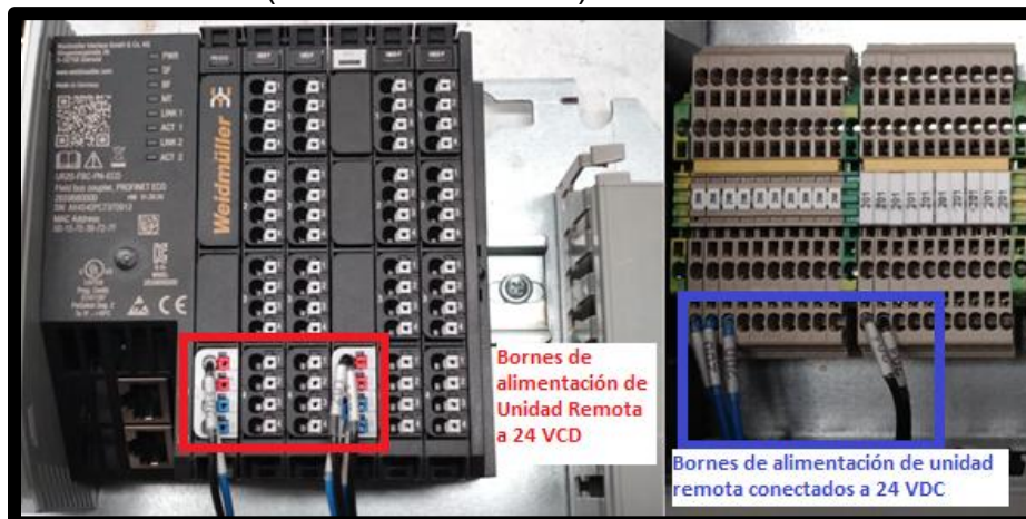
Figura 3.105 Cableado alimentación de unidad remota
