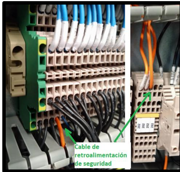
Figura 3.120 Cableado señal de seguridad en tablero eléctrico
