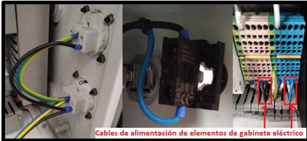
Figura 3.128 Conectando elementos de gabinete eléctrico
