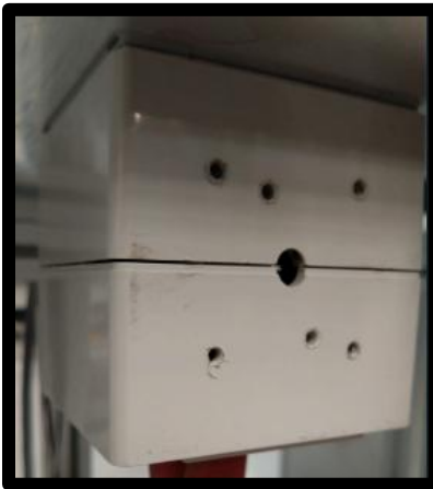
Figura 3.58 Carcasa de seccionadores
