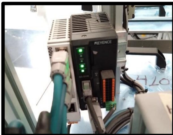
Figura 3.138 Switch ethernet y controlador de sistema de visión de herramental
