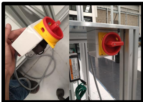
Figura 3.93 Instalando interruptores seccionadores en estaciones
