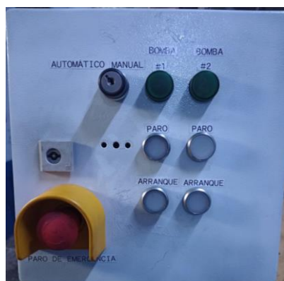
Ilustración 225. Etiquetado de tablero
