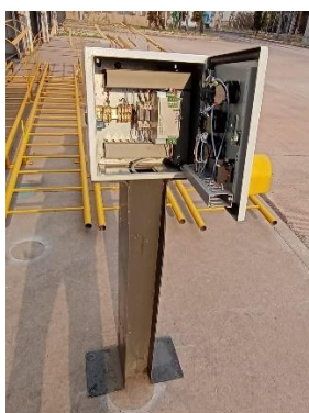
Ilustración 220. Tablero eléctrico internamente
