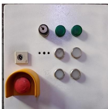
Ilustración 202. Puerta de tablero eléctrico con componentes
