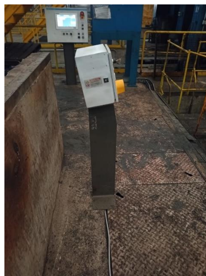
Ilustración 223. Cableado del tablero
