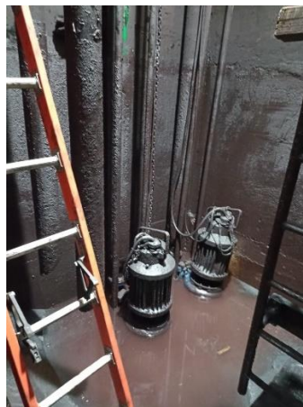
Ilustración 233. Bombas sumergibles en sótano DSD
