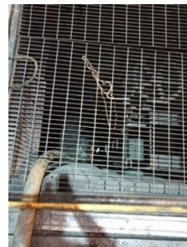
Ilustración 23. Vista superior bombas
