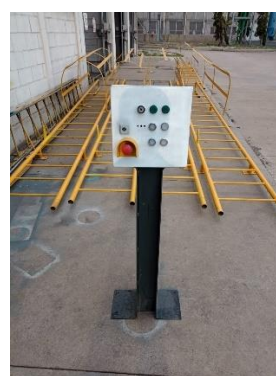
Ilustración 221. Tablero eléctrico externamente
