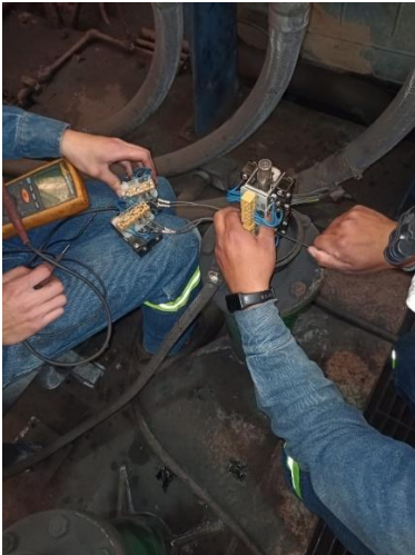
Ilustración 16. Apoyo en fallas eléctricas de DSD
