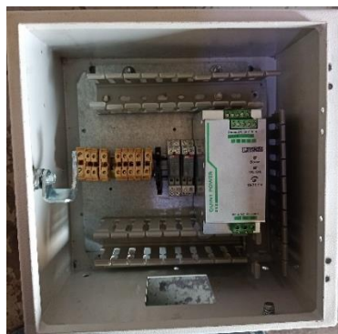
Ilustración 207. Fijación de placa con componentes en caja de tablero
