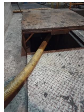
Ilustración 25. Desfogue de agua de DSD
