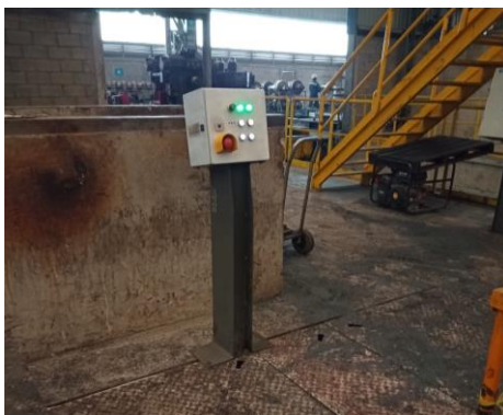
Ilustración 224. Tablero eléctrico instalado y encendido
