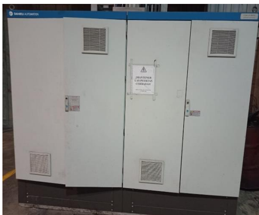
Ilustración 47. Tablero de remota DSD
