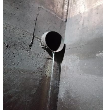
Ilustración 227. Canal de agua DSD
