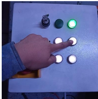
Ilustración 219. Accionamiento de bomba 2
