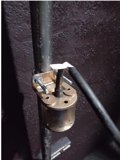
Ilustración 231. Sensor fijado a tubo
