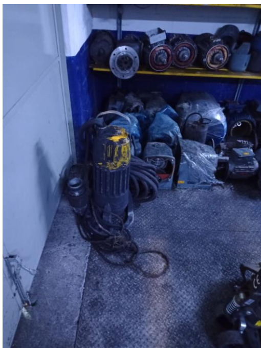
Ilustración 241. Bombas de emergencia
