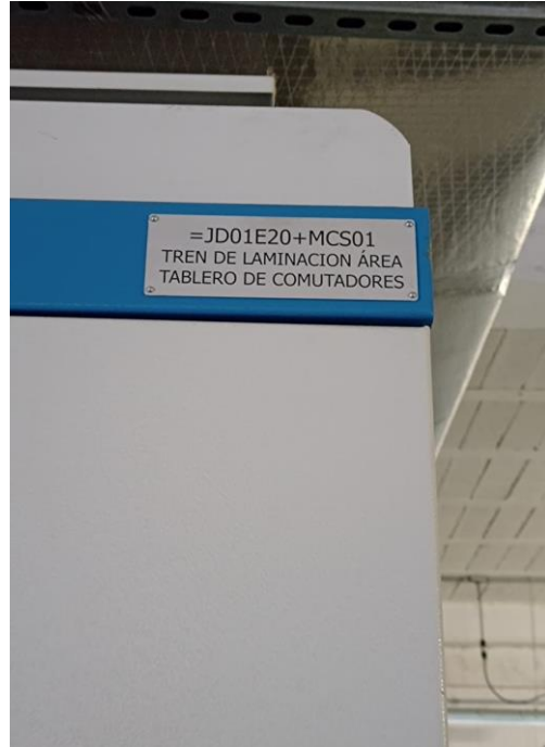
Ilustración 32. Placa de tablero bombas DSD
