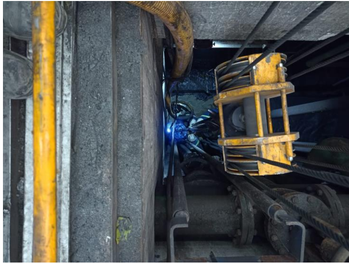
Ilustración 243. Mantenimiento eléctrico en fosa DSD
