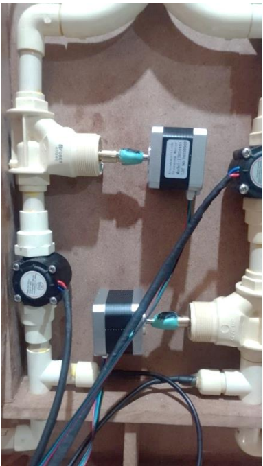
Figura 205 Válvulas abiertas a la mitad debido a que el error es cercano a cero.
