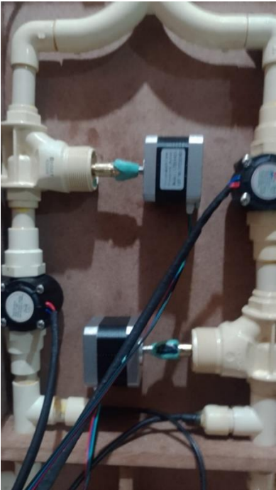
Figura 207 Cambio en la apertura de las válvulas .
