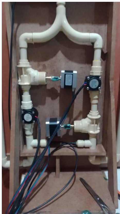
Figura 209 Válvulas cerradas por completo.
