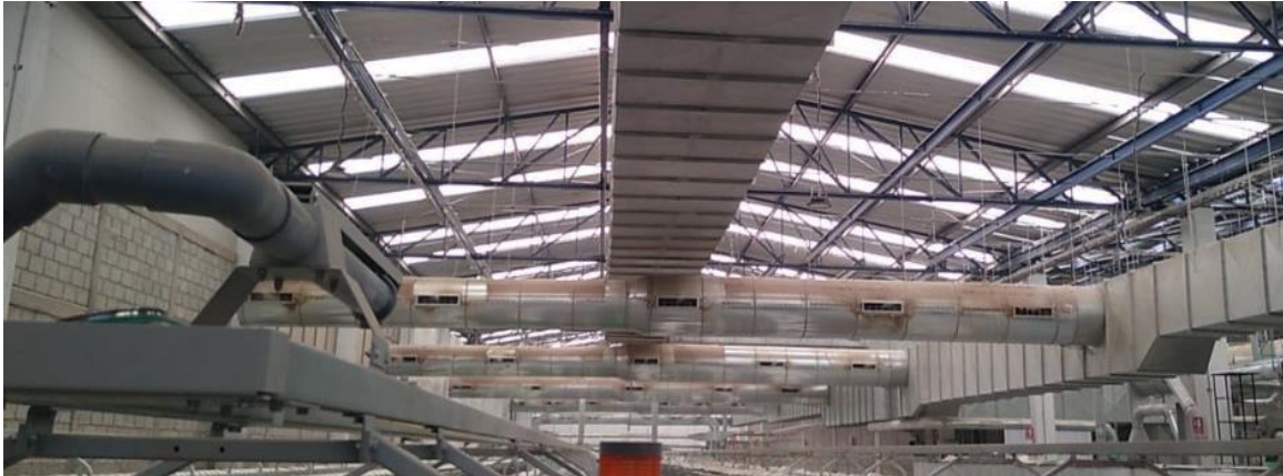
Ilustración 2.12. Central de Humidificación
