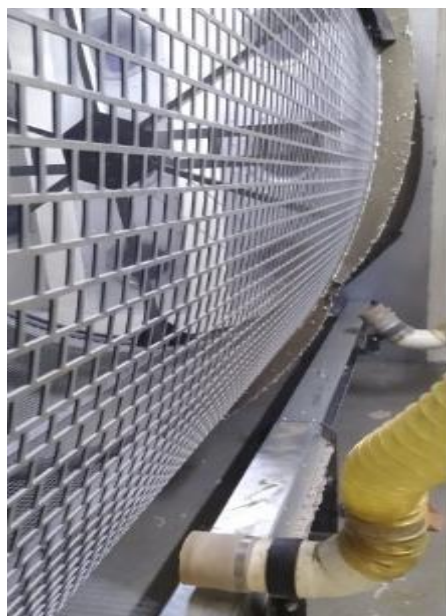
Ilustración 4.10. Cambio de filtro poliuretano de central aeris
