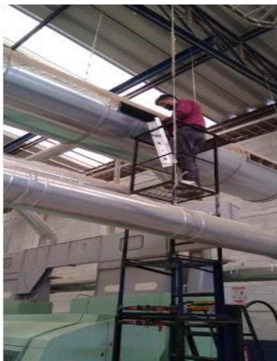
Ilustración 4.15. Limpieza e inspección de las boquillas de pulverización de la central de humidificación.
