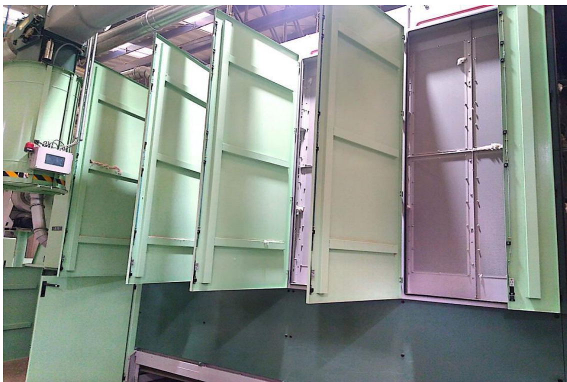
Ilustración 4.7. Unimix, Almacenamiento de Material y limpieza de polvo en cubiertas.
