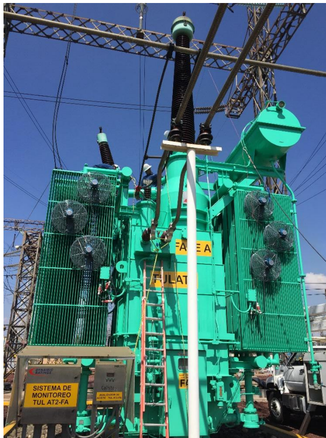
Figura 6.1 Transformador de potencia siendo revisado por personal de CFE
