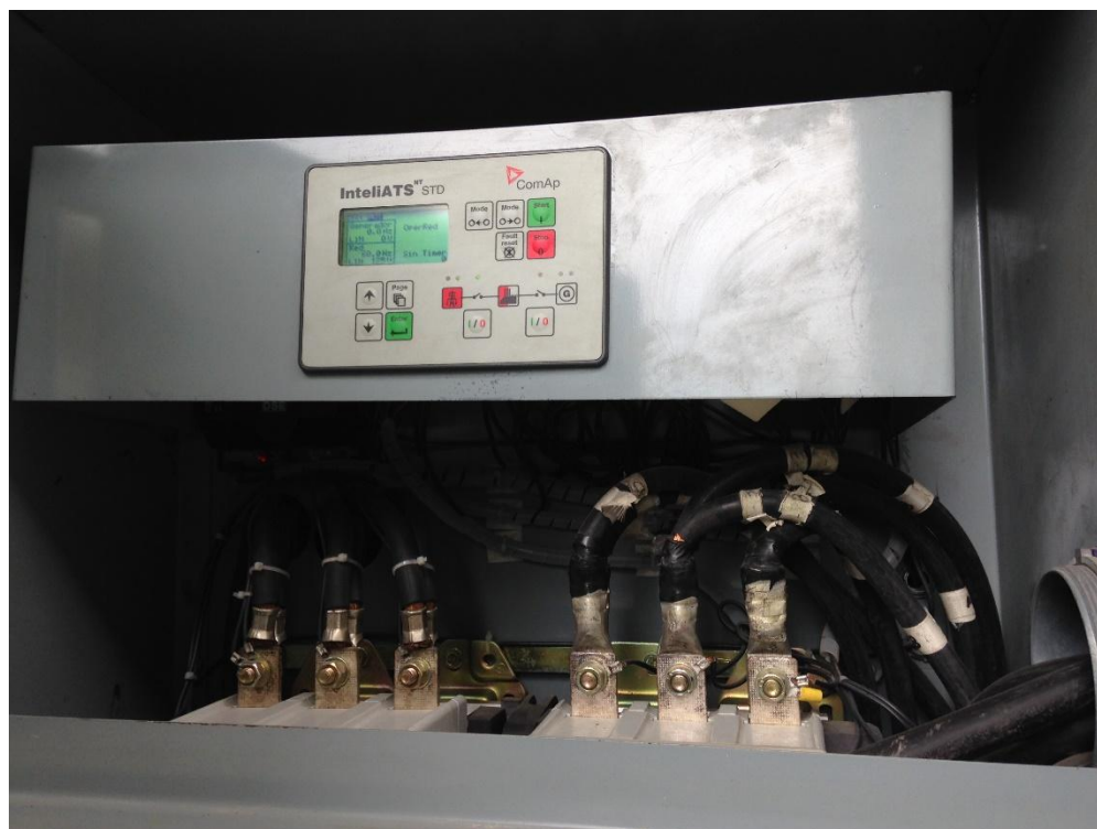
Figura 2.19 PLC de control del encendido de la planta de emergencia
