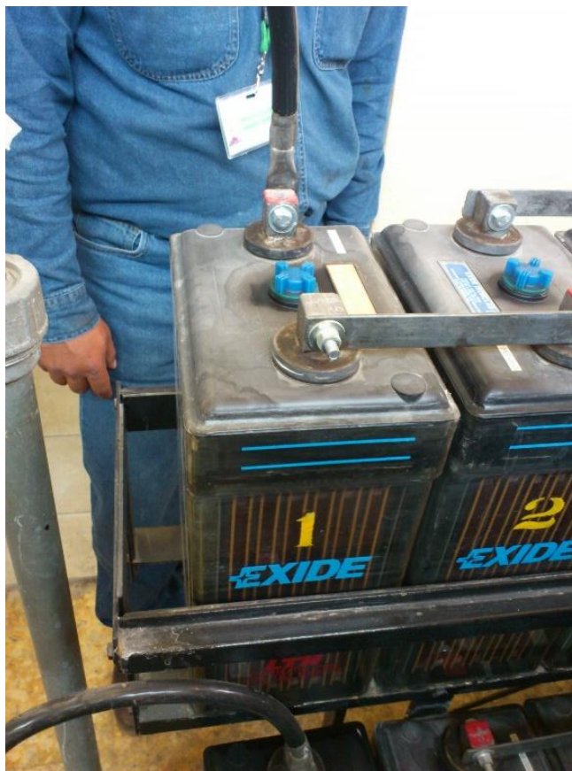
Figura 6.13 Revisión de niveles de electrolito
