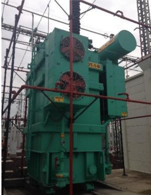
Figura 1.3 Transformador de potencia
