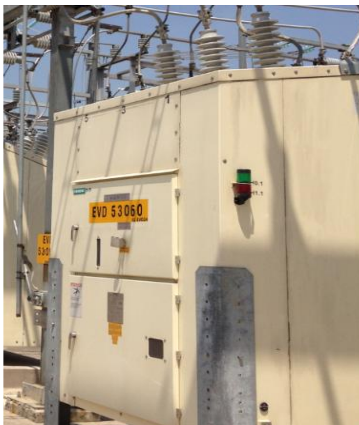
Figura 2.4 Interruptor de vacío, tanque muerto con mecanismo de resorte
