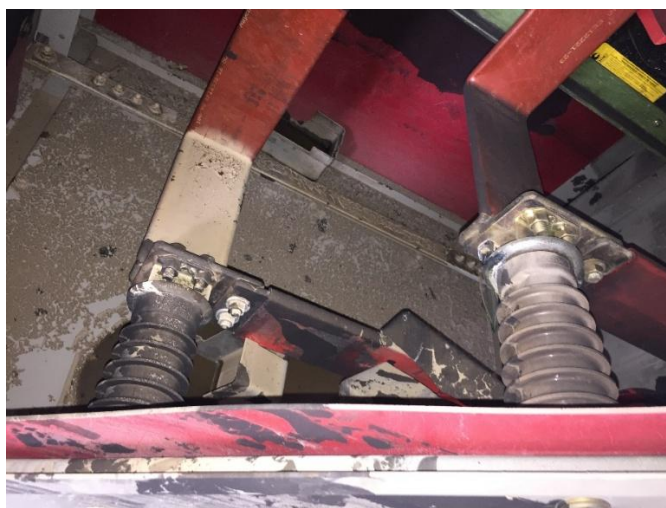
Figura 6.26 Aisladores y aislante de barras dañados
