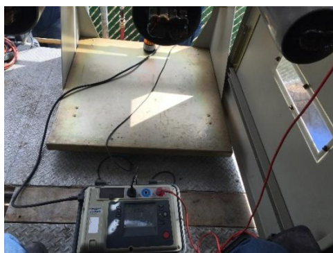
Figura 6.12 Realizando prueba de resistencia de aislamiento a interruptor de 23 KV's
