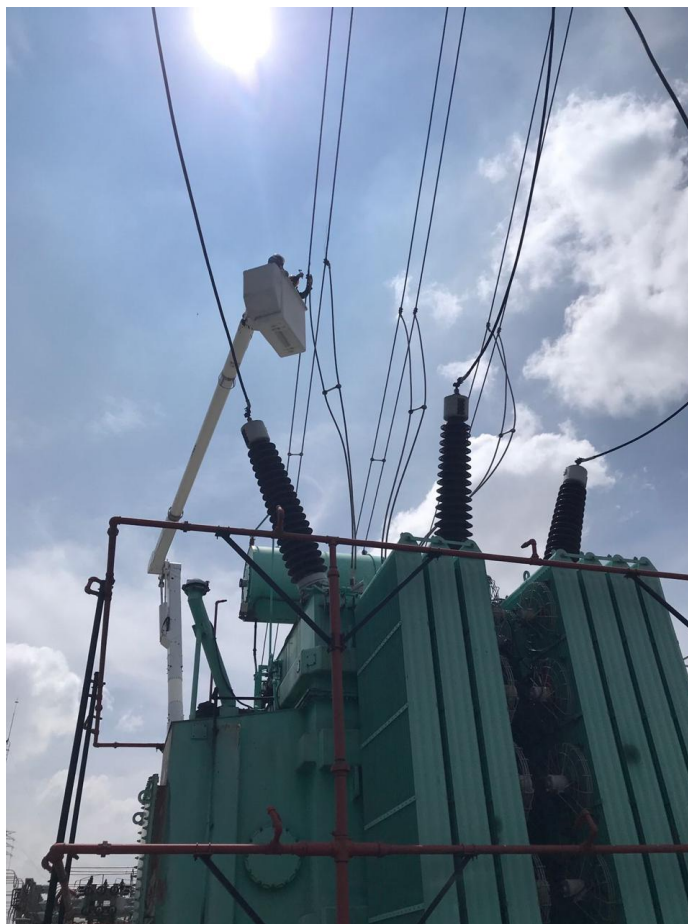
Figura 6.4 Transformador de potencia VAJ T-05 siendo desconectado por personal de CFE
