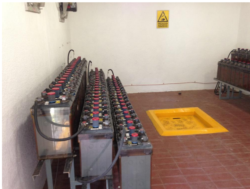
Figura 6.16 banco de baterías de S.E. CEILAN
