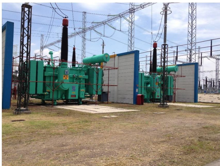
Figura 2.21 Apartarrayos de protección de banco de transformación de 400 Kv's
