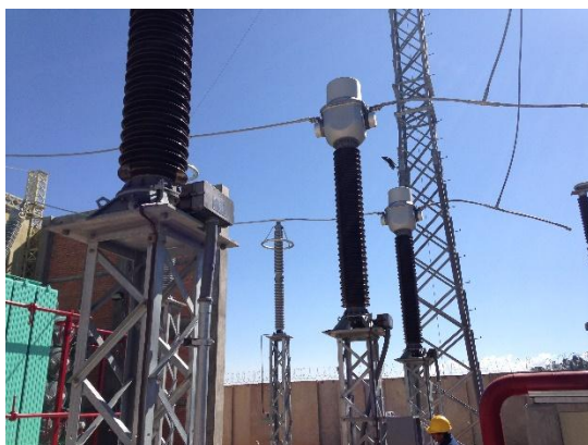
Figura 2.8 Transformador de corriente tipo pedestal
