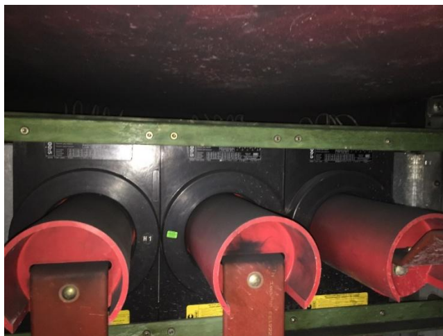
Figura 6.25 Pasamuros de interruptor dañados
