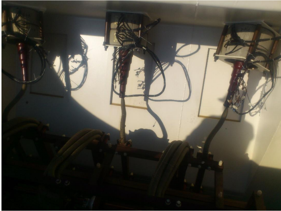
Figura 6.21 Transformadores tipo dona del transformador T82
