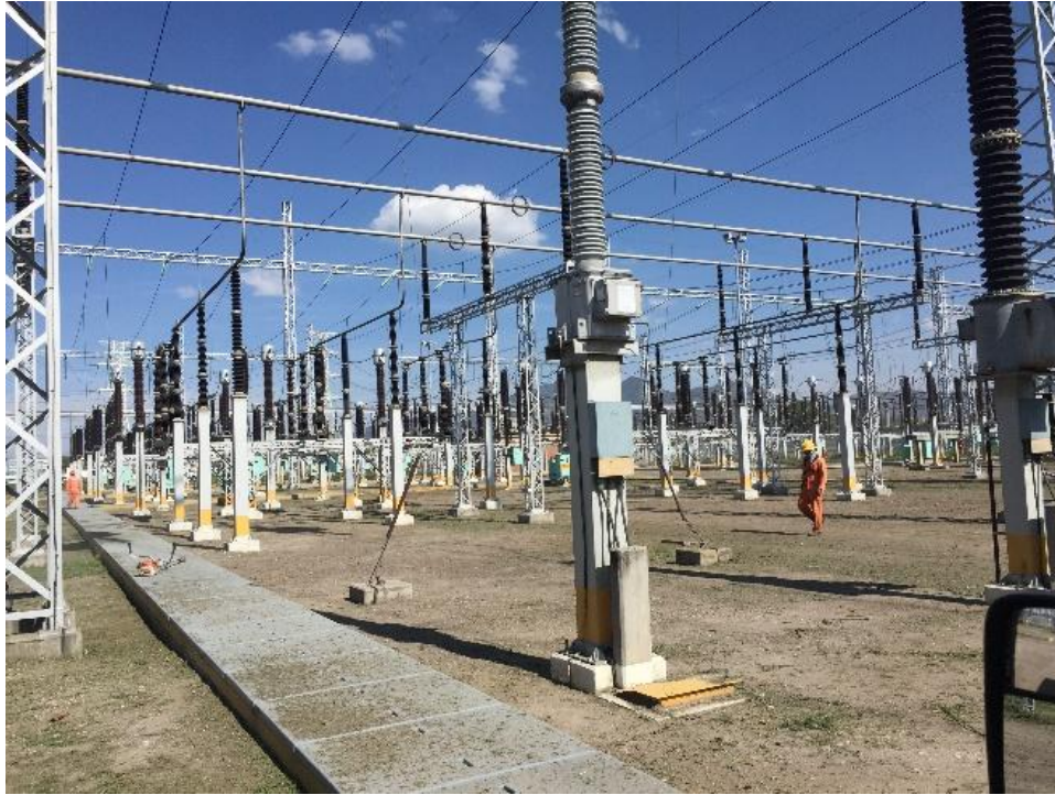
Figura 2.11 Transformador de potencial inductivo-capacitivo
