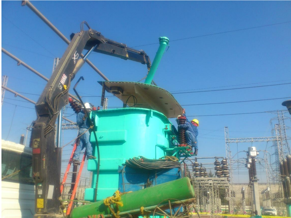
Figura 6.19 Retiro de tapa y desprendimiento de empaque dañado
