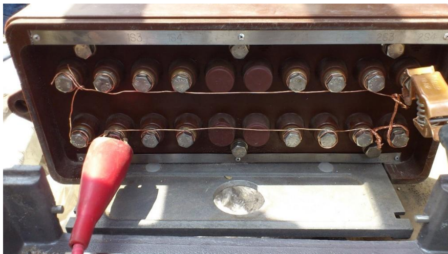
Figura 6.7 Conexión de prueba de factor de potencia a TC's
