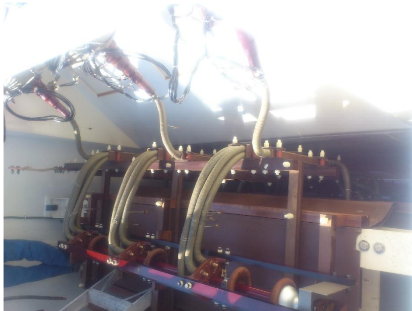
Figura 6.20 Devanados del transformador T82
