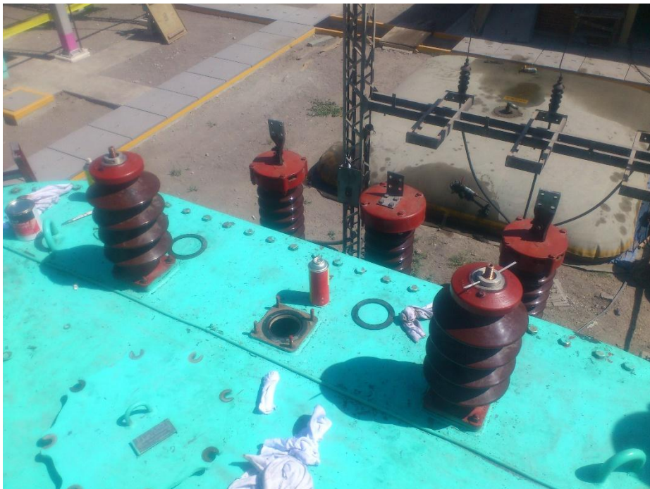
Figura 6.22 re-empaquetamiento de boquillas
