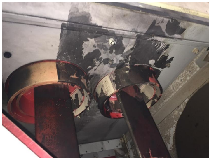
Figura 6.27 Pasamuros de barras dañado
