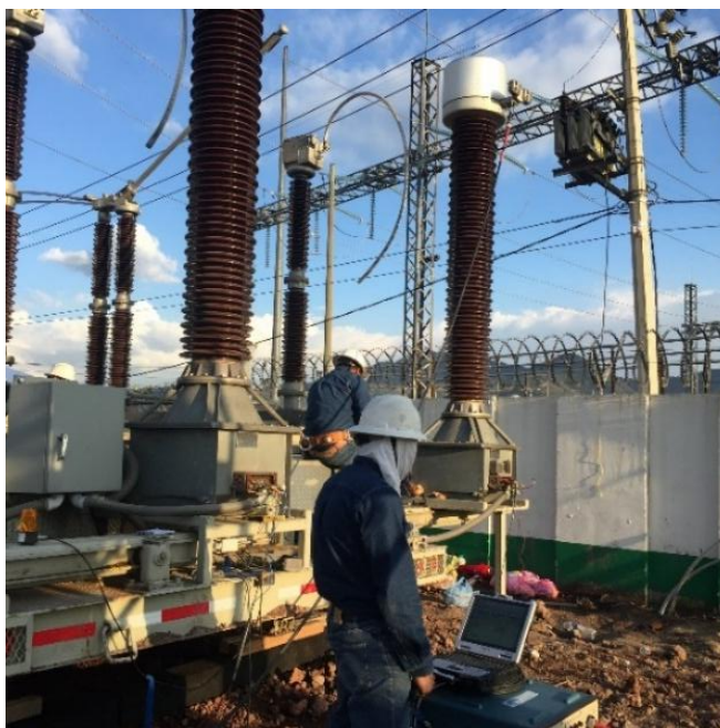
Figura 6.9 Realizando prueba de factor de potencia a TP's
