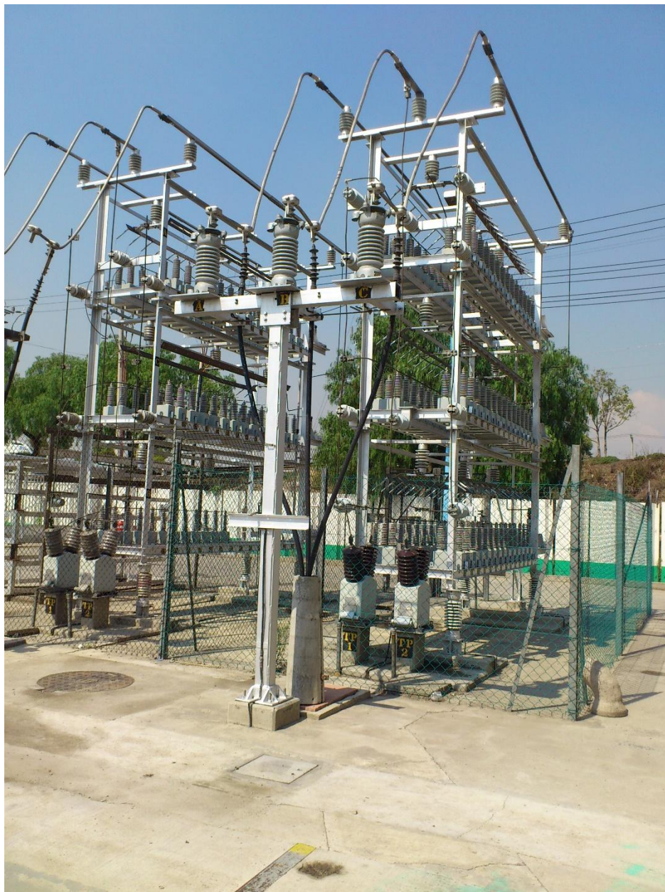
Figura 2.13 Banco de capacitores para sistema de 23 Kv's
