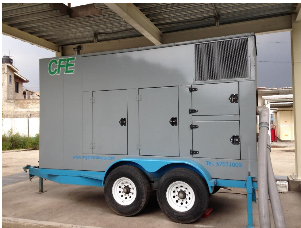
Figura 2.18 Planta de emergencia con generador cumins
