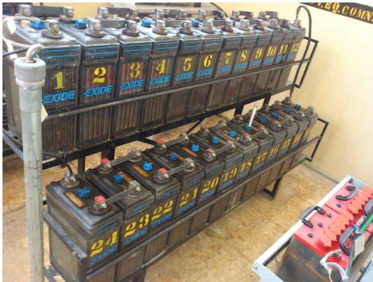
Figura 6.14 Cuarto de baterías limpio
