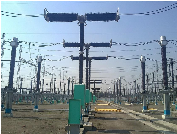
Figura 1.2 Vista de bahías de una subestación
