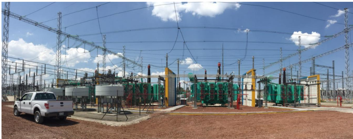
Figura 2.14 Reactor de potencia acoplado a transformador de 400 Kv's
