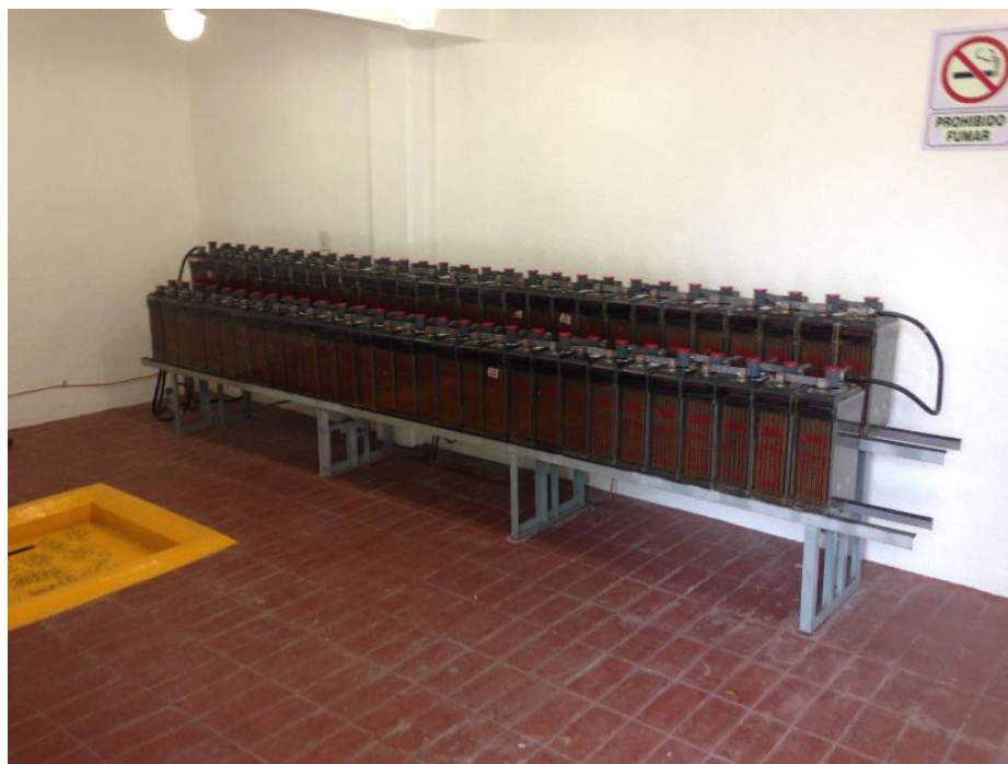
Figura 6.15 banco de baterías de S.E. CEILAN
