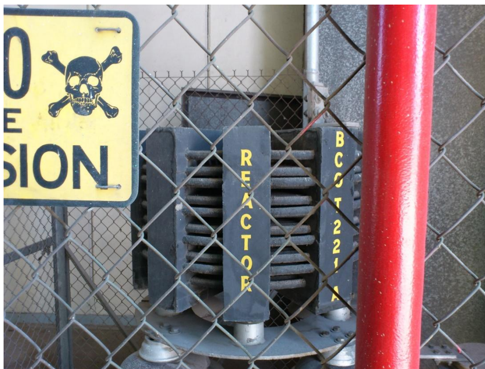
Figura 2.15 Reactor de potencia acoplado en neutro de banco de transformación de 230/23 Kv's
