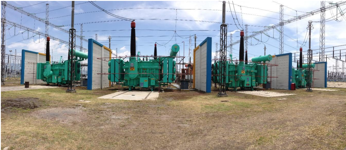
Figura 1.1 Subestación eléctrica de potencia
