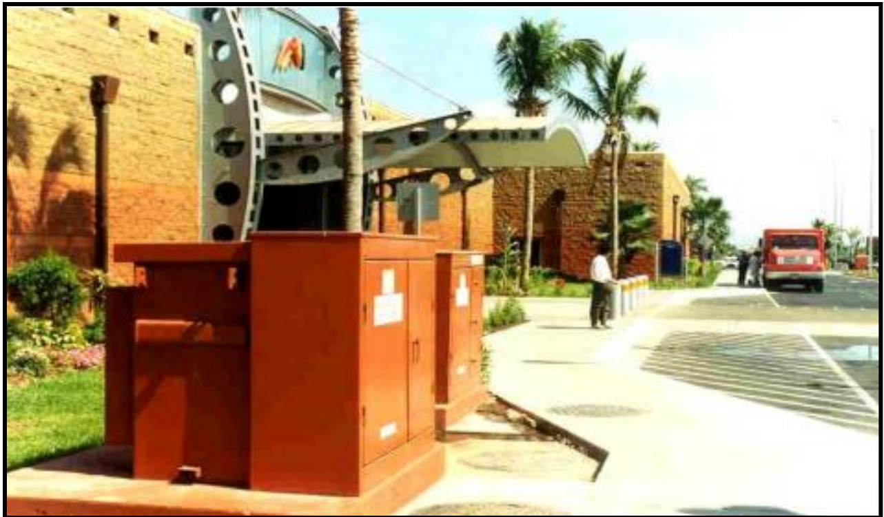
Fig.2. 21. Centro comercial con red subterránea.
