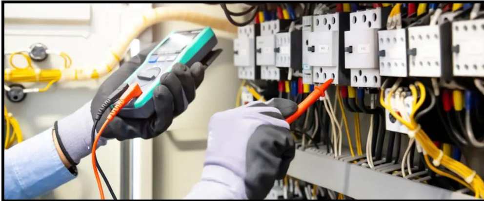
Fig. 4.31. Protección de equipos eléctricos.
