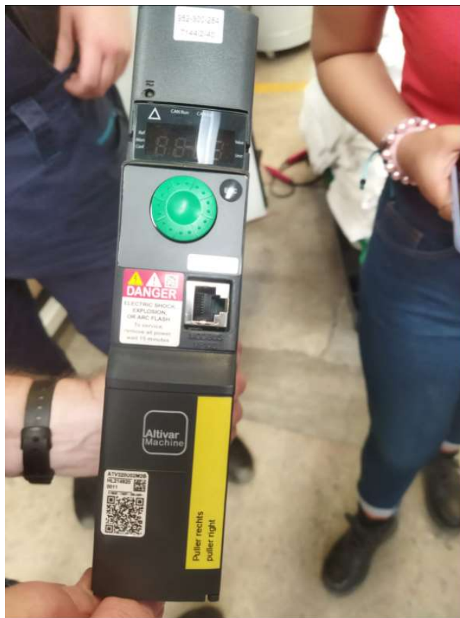
Figura 4.49 Cambio de variador ALTIVAR dañado
