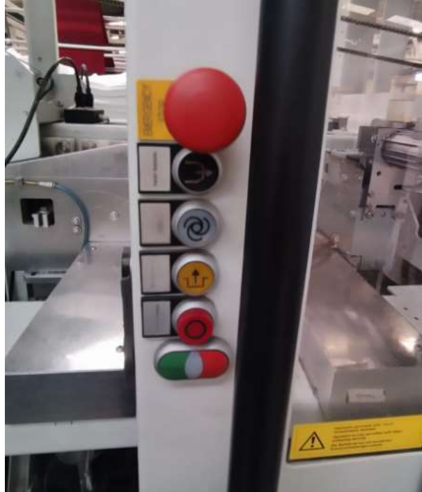
Figura 4.14 Control de apoyo secundario con paro de emergencia
