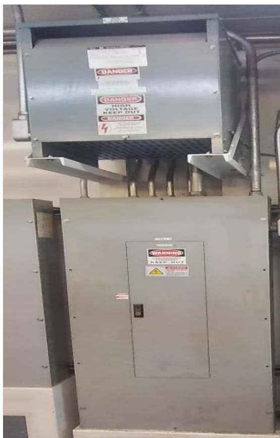
Fig. 46. Trafo A el cual representa la carga critica a mantener energizado en todo momento. (fuente: GIA, 2024).
