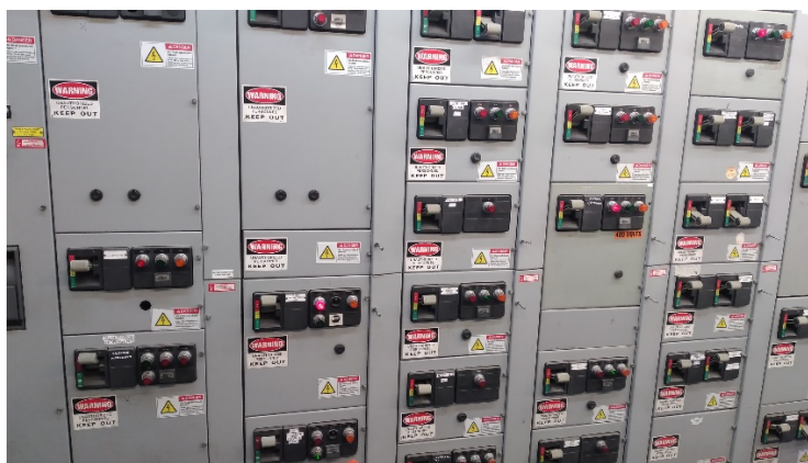
Fig. 42. Área de control de motores dentro del CCM. (fuente: GIA, 2024)
