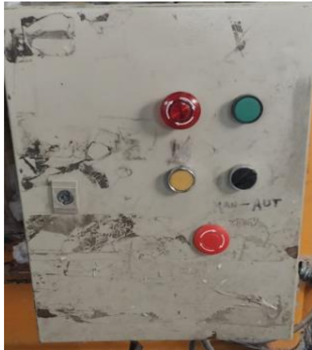
Figura 14. antiguo tablero de control de máquina compactadora con botón de arranque, botón de paro y selector “automático o manual”
