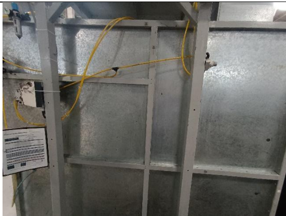
Ilustración 75 Cabina de adhesivo antes
