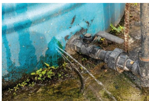
Figura 1 Fuga de agua en tinaco
