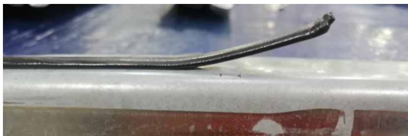
Ilustración 40: Desprendimiento de sello
