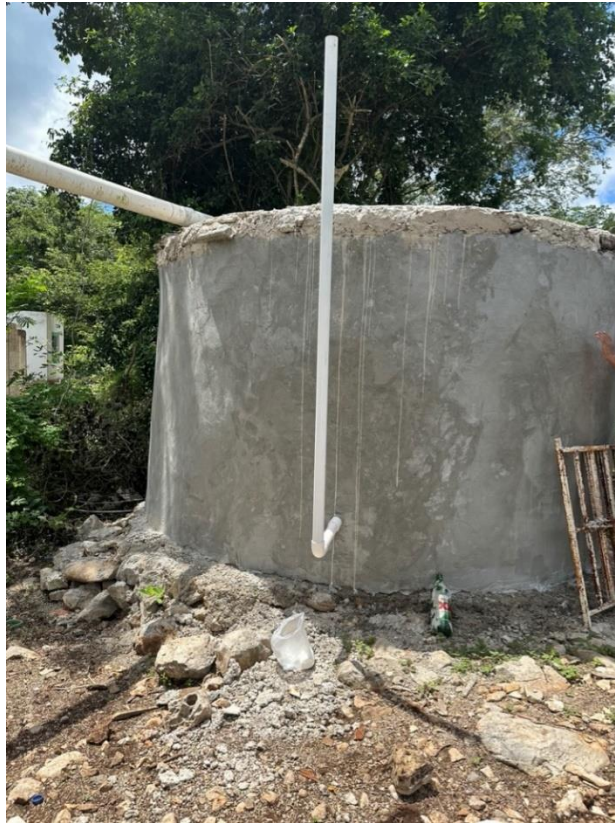
Figura 39. Tinaco y el PVC hidráulico
