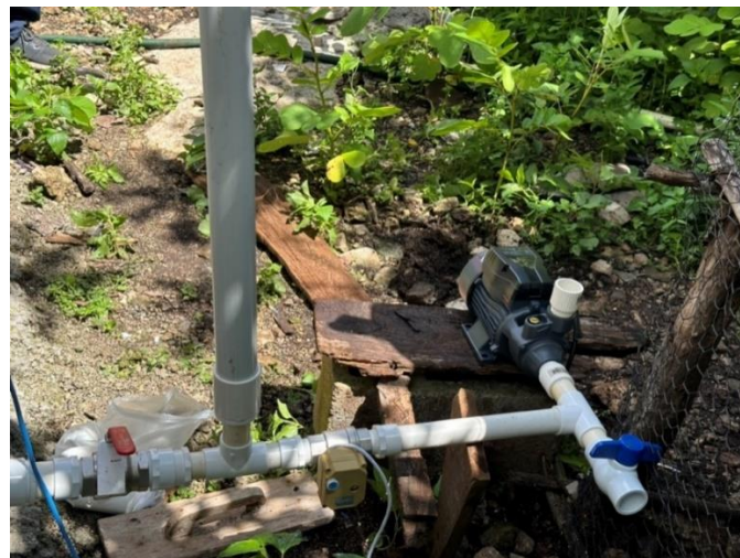
Figura 42. Control del nivel del agua
