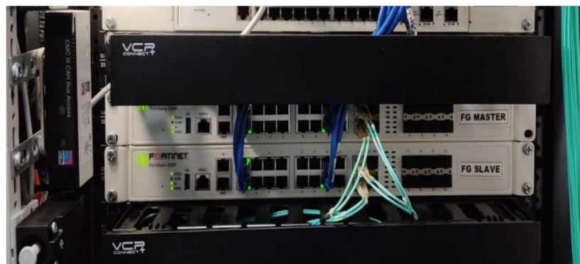
Figura 51. Fortigate Conexión física después. (ENVATEC, 2024)
