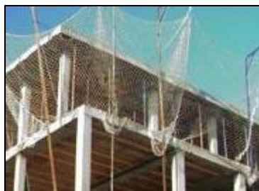
Ilustración 49. Falta de continuidad en columnas
