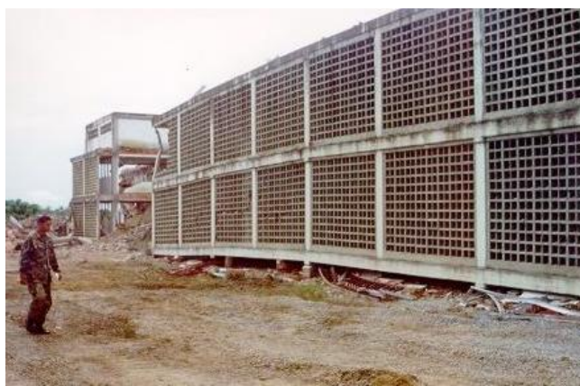
Ilustración 59. Colapso total de la planta baja del edificio.
