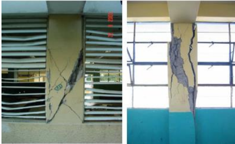
Ilustración 75. Falla típica de columna corta
