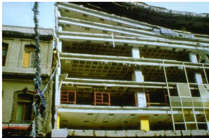
Ilustración 71. Colapso total de pisos superiores
