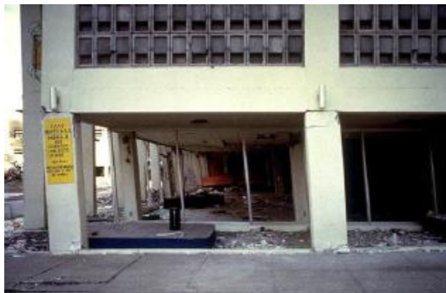
Ilustración 58. Daño estructural por planta débil conllevó a la inutilización del edificio
