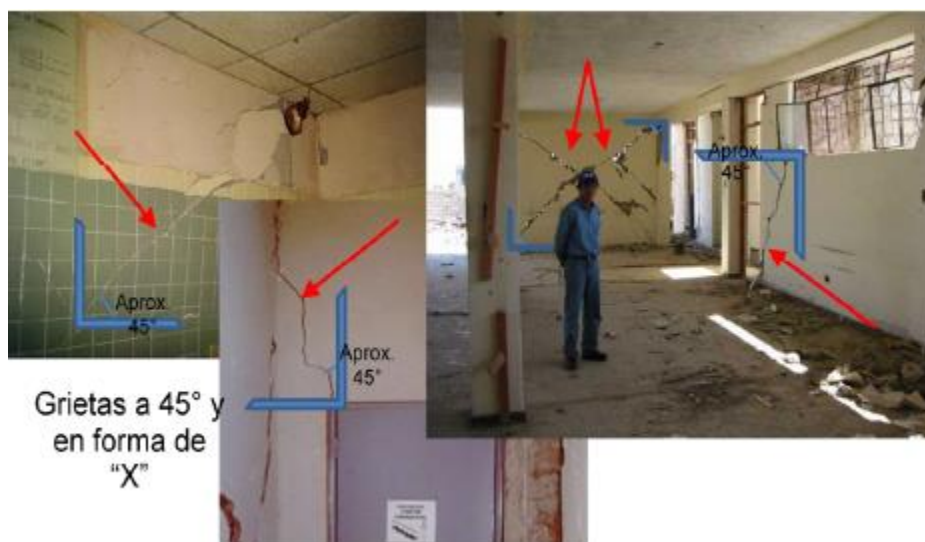
Ilustración 62. Típica grieta originada en tabiquerías por eventos sísmicos
