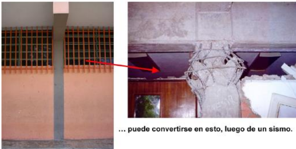
Ilustración 74. Falla de columna corta (fotos típicas de instituciones educativas)
