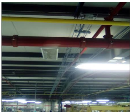
Figura 3 Canalización en techo vista horizontal A
