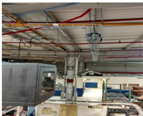
Figura 4 Canalización en techo vista horizontal B
