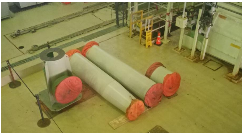
Figura 81. Bomba de reserva ubicada en el edificio de obra de toma
