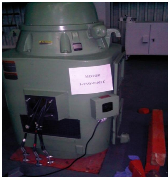
Figura 3. Motor sin inspección.
