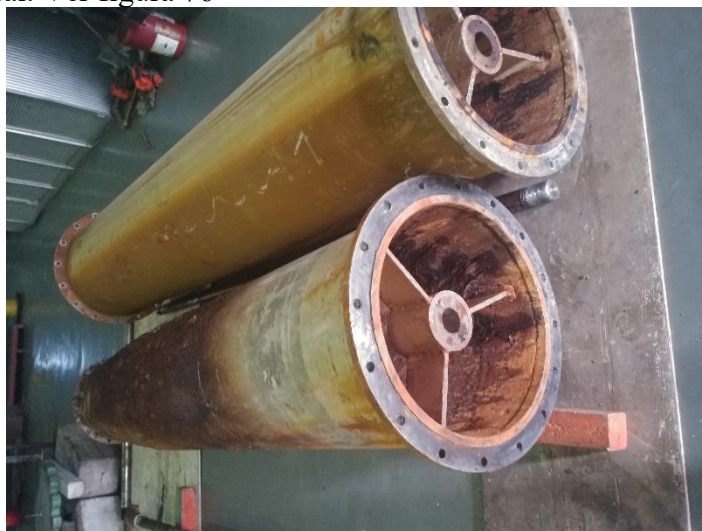
Figura 76. Columnas del desensamble de la bomba.
