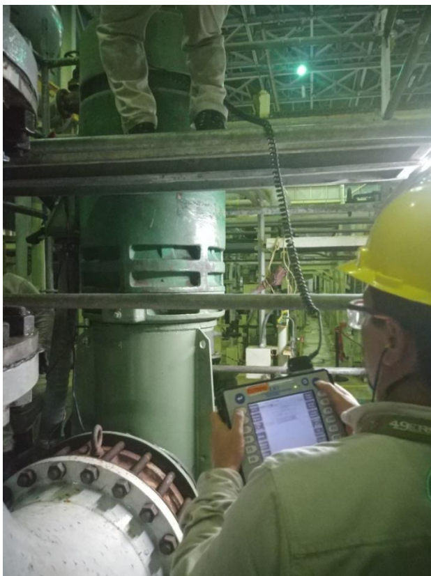
Figura 117. Toma de vibraciones de la bomba.
