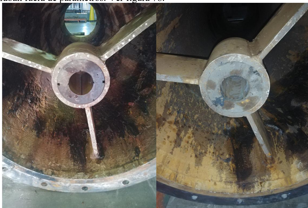
Figura 78. Inspección de chumaceras gastadas.
