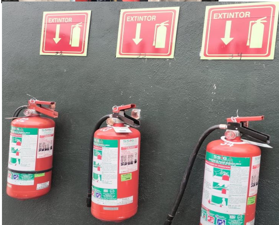
Figura 9. Señalización y colocación de extintores.
