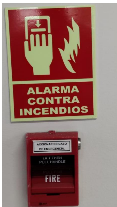
Figura 8. Alarma contra incendios.
