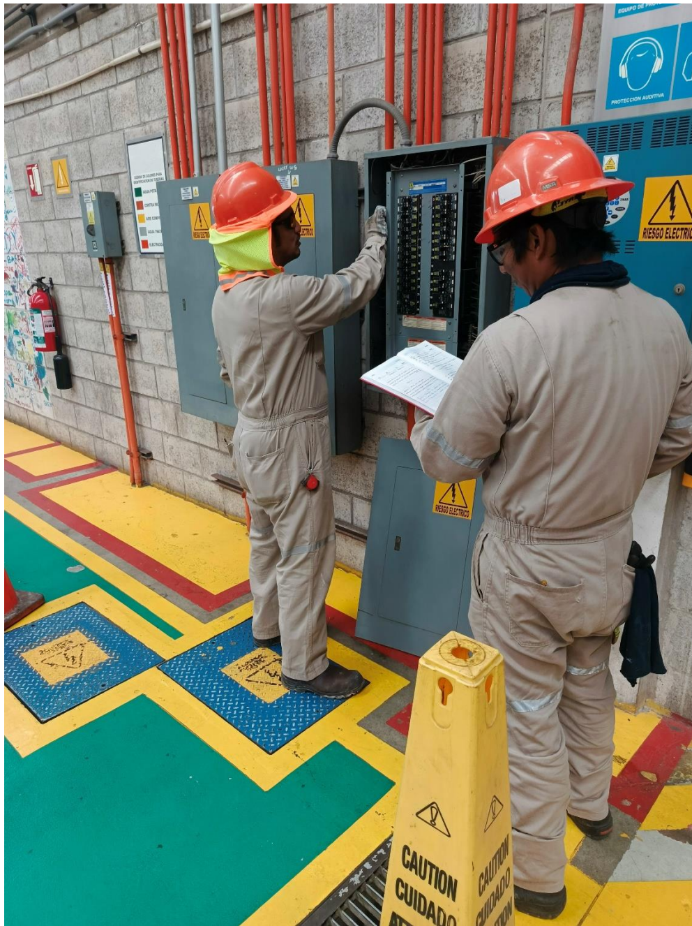
Anexo 1 Supervisión de mantenimiento de tableros eléctricos
