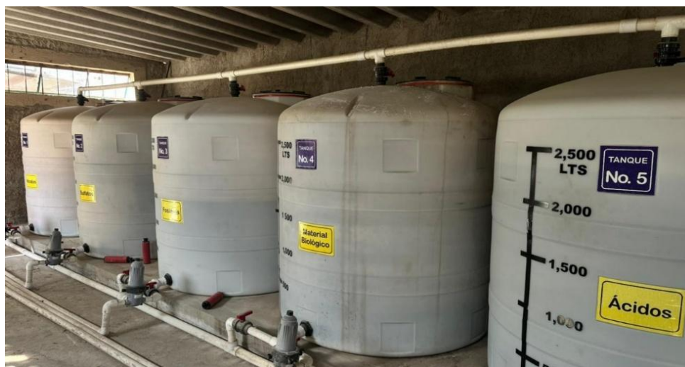
Figura 15-Tanques cuarto de riego
