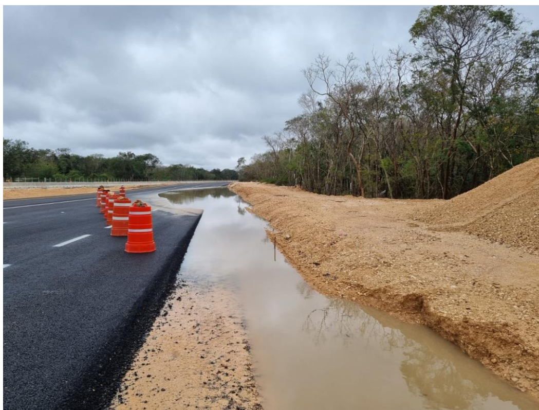
Imagen 10. Zona de acumulación de agua, derivado de los trabajos de terracería.
