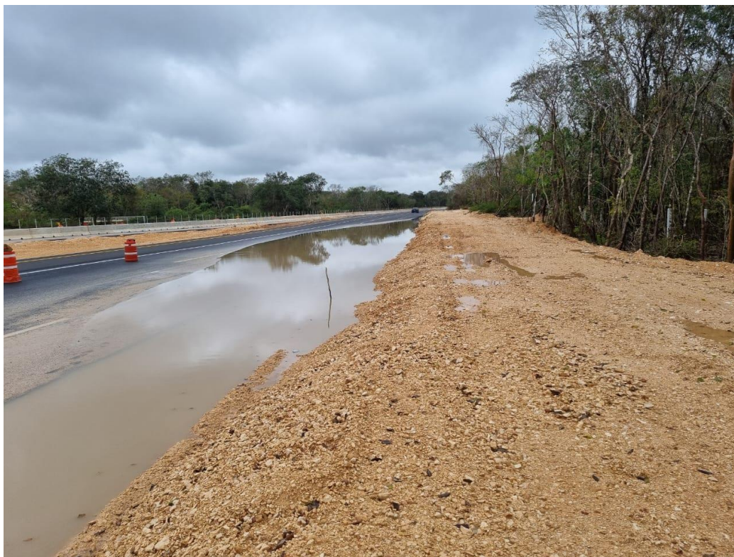
Imagen 8. Zona de afectación en el hombro izquierdo de la autopista.
