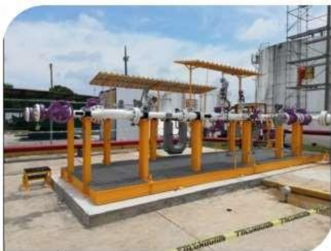
Sistema de Medición de Hidrocarburos.
