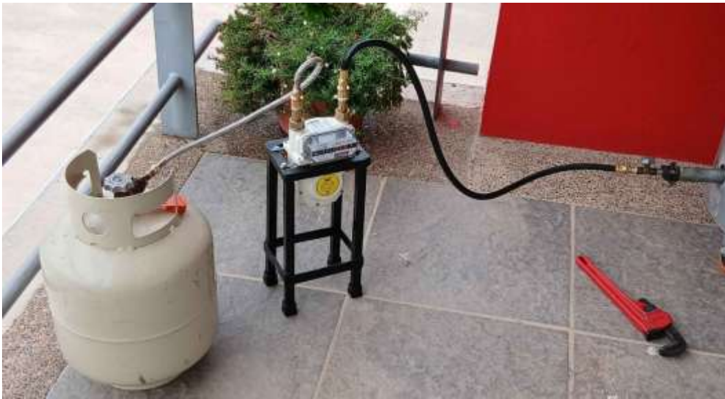
Figura 36. Vista completa del sistema de suministro de energía por gas LP.
