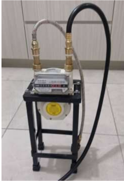
Figura 34. Medidor empotrado en una base metálica.
