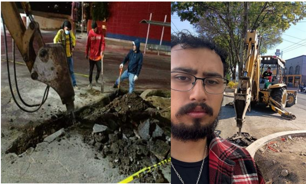
Ilustración 10 Ruptura de carpeta asfáltica en tramos de retorno. Fuente propia
