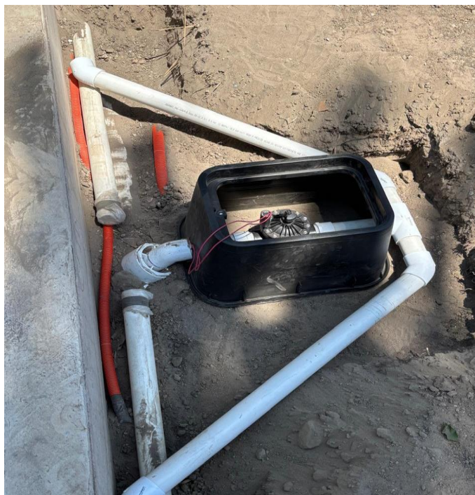
Ilustración 3 Imagen del modelo de válvula solenoide ocupada en el sistema junto toda la instalación requerida. Fuente propia
