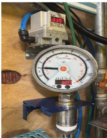
Figura 16.1 Instalación física del regulador electroneumático y el sensor de presión con pantalla analógica.
