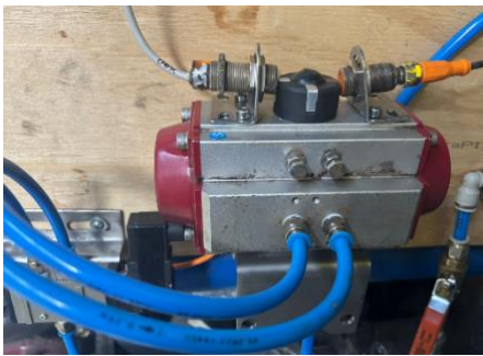
Figura 16.2 Instalación física de los sensores y la válvula ON/OFF.
