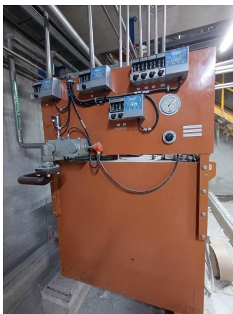
Ilustración 10 Área lubricación, Fuente: Propia
