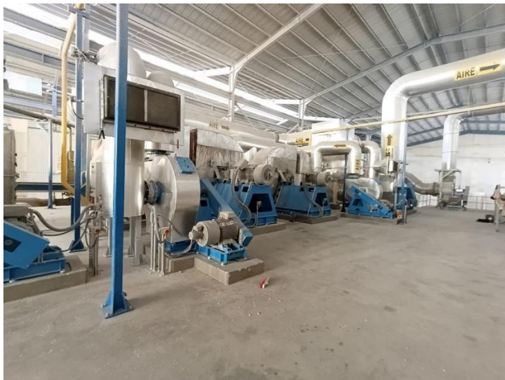
Ilustración 12 Área quemadores Fuente: Propia
