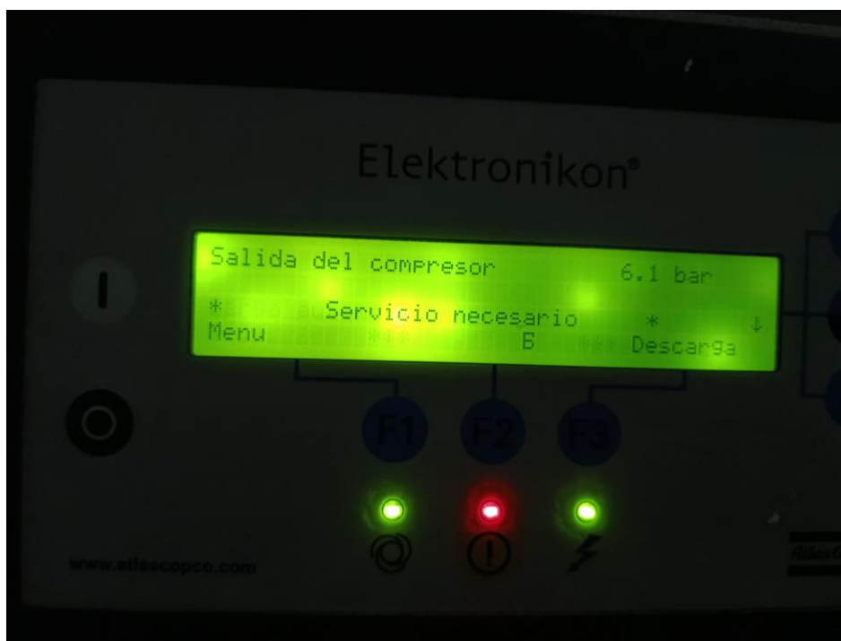
Ilustración 25 Pantalla compresor 8 Fuente: Propia
