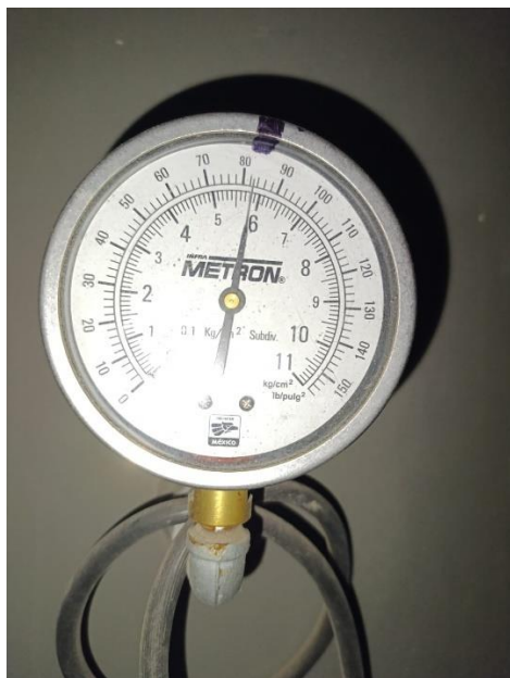
Ilustración 24 Manómetro tanque pulmón compresores Fuente: Propia
