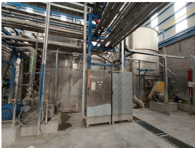
Ilustración 9 Área tanques Fuente: Propia
