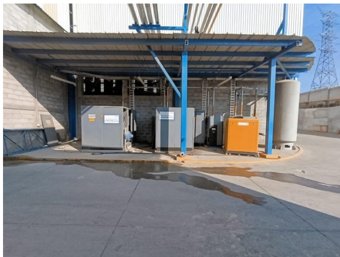
Ilustración 13 Área compresores Fuente: Propia
