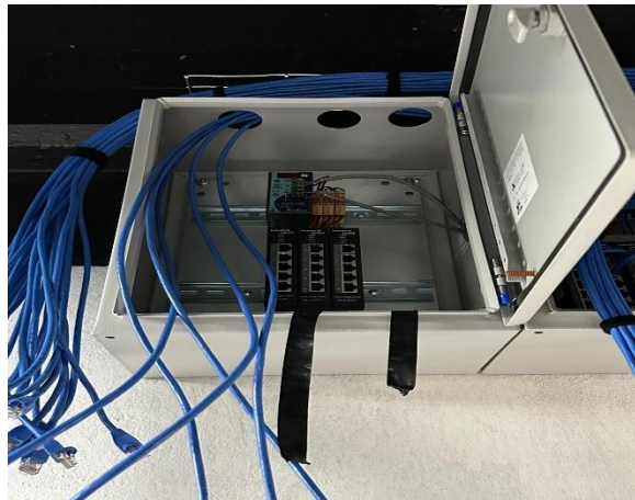
Ilustración 39 Gabinete de swtiches con pasos (Autoría Propia)
