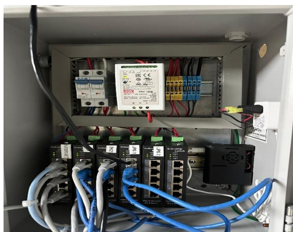
Ilustración 43 Conexiones en gabinete principal (Autoría Propia)
