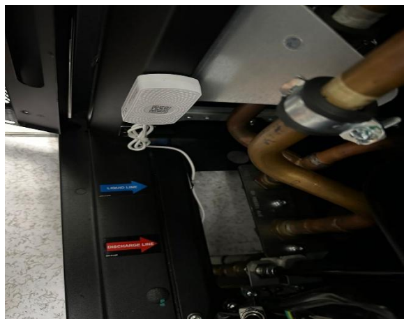
Ilustración 15 Instalación de sensor de Temperatura y Humedad (Autoría Propia)
