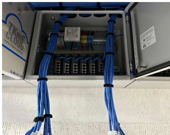
Ilustración 40 Gabinete principal con pasos (Autoría Propia)
