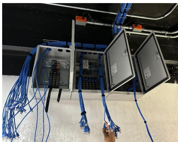
Ilustración 41 Gabinete conectado a la alimentación (Autoría Propia)
