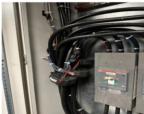
Ilustración 33 Instalación de Transformadores de Corriente (Autoría Propia)
