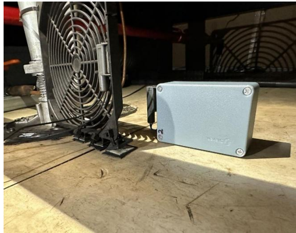
Ilustración 24 Ubicación Aire Perimetral (Autoría Propia)
