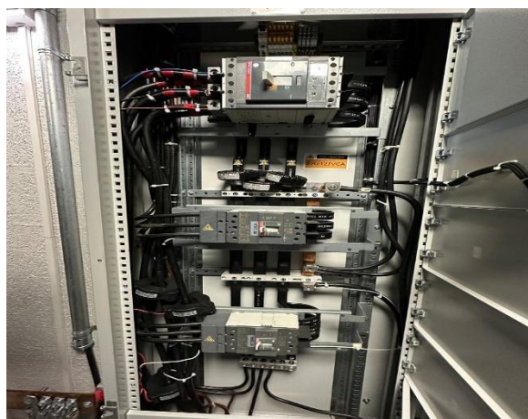
Ilustración 32 Cableado hacia el CPM 50 (Autoría Propia)
