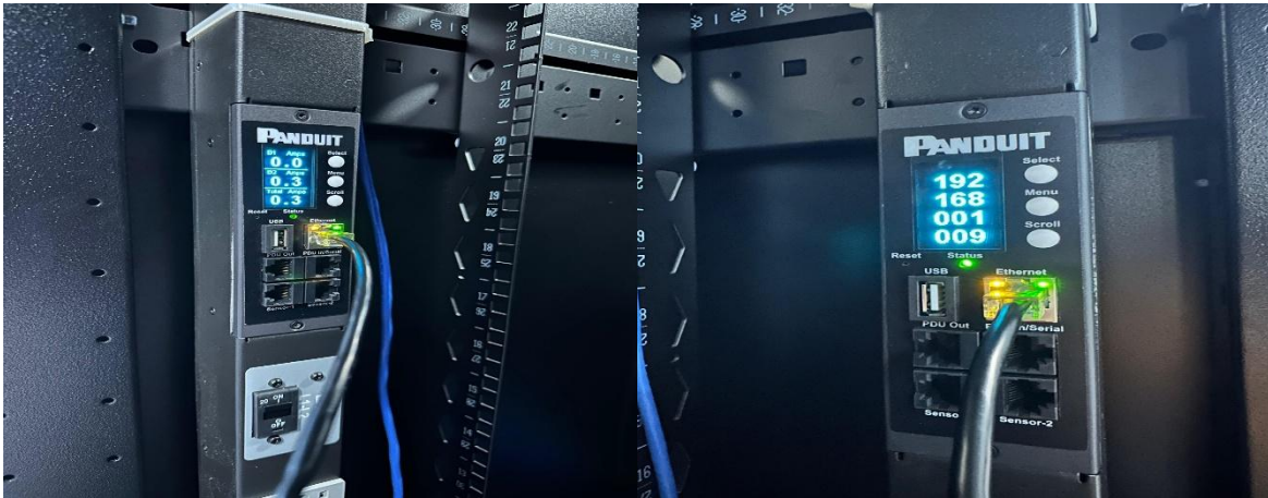
Ilustración 47 Equipo PDU Panduit (Autoría Propia)
