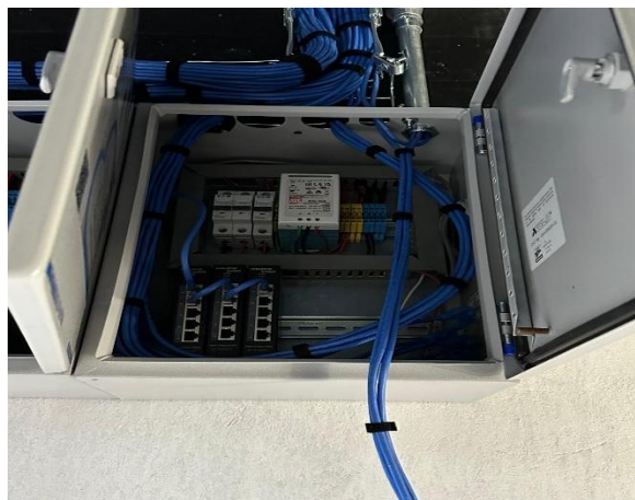
Ilustración 42 Punteo de Switches (Autoría Propia)
