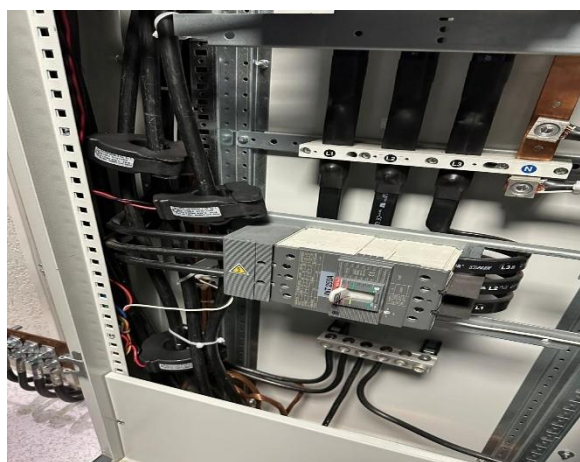
Ilustración 35 Correcta colocación de los Transformadores (Autoría Propia)
