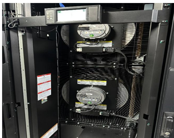
Ilustración 51 Vista general del equipo InRow
