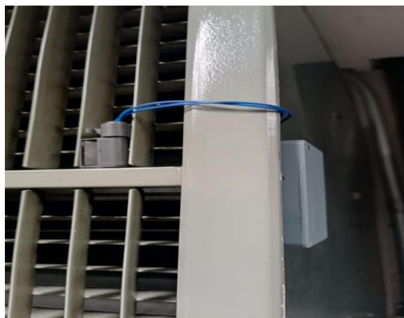
Ilustración 25 Ubicación Aire Perimetral (Autoría Propia)
