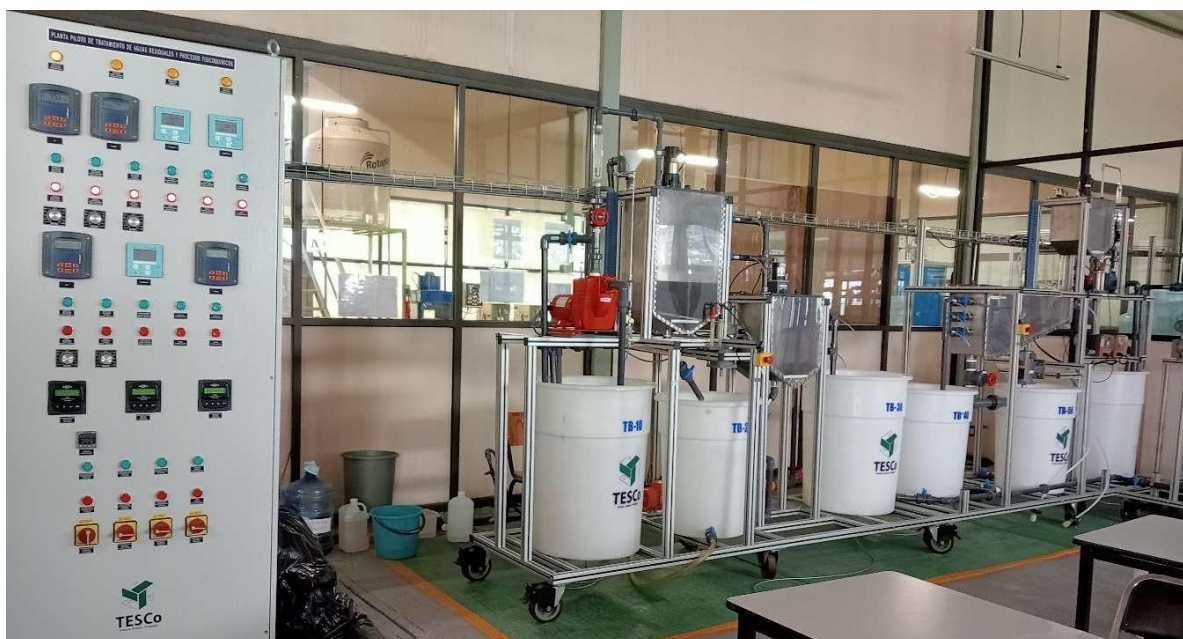
Figura 59. Planta Piloto de Tratamiento de Aguas Residuales del TESCo
