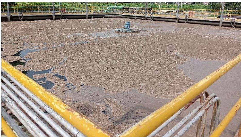
Figura 52. Reactor B en fase de sedimentación
