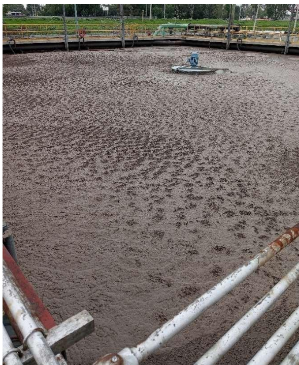
Figura 36. Reactor B en fase de sedimentación
