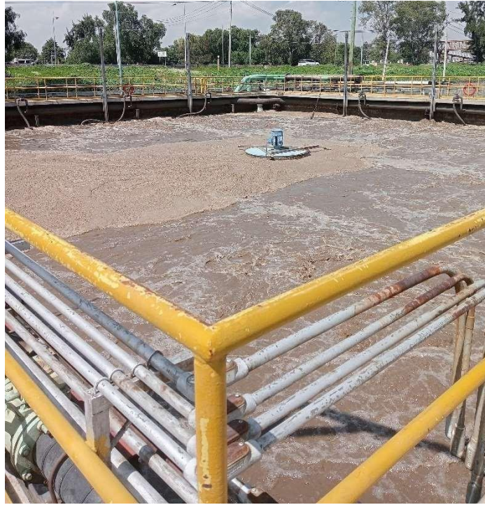
Figura 43. Reactor B en fase de llenado con mezclado
