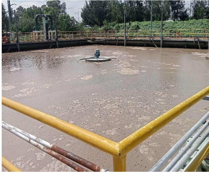
Figura 40. Reactor A en fase de sedimentación
