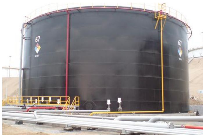
Imagen 2.8. Tanque cerrado usado para almacenar combustible.
