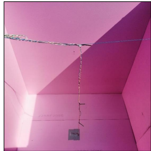
Figura 4. 45. Sensores instalados al interior de la cavidad
