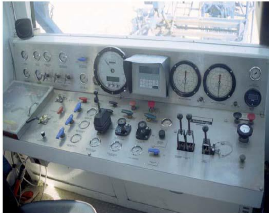
Ilustración 14 Cabina de control.
