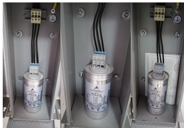
Figura 5.7: Banco de capacitores
