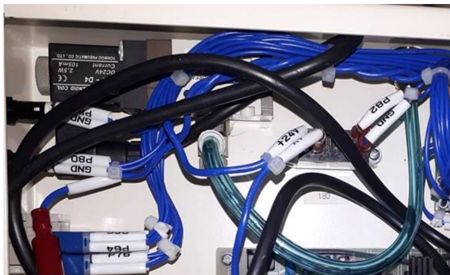
Figura 5.4. Electroválvula instalada en la fuente de alimentación
