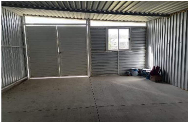
Imagen 7. Vista frontal del almacén temporal de residuos de manejo especial.
