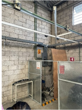
Imagen 11. Tablero principal y de distribución dentro del inmueble.
