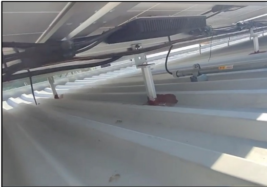
Figura 50 Detalle de fijación de los microinversores
