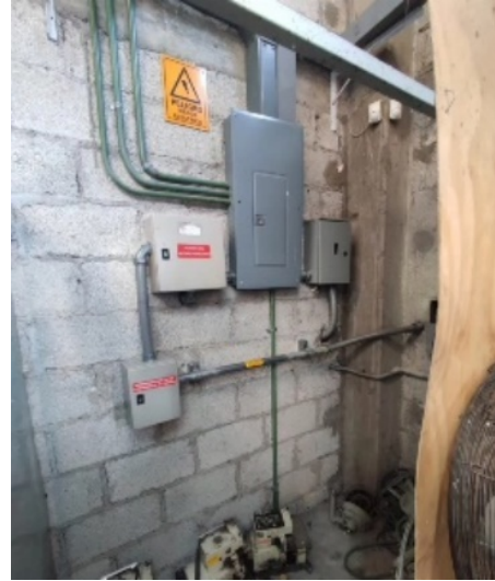
Figura 56 Tablero principal y tablero fotovoltaico
