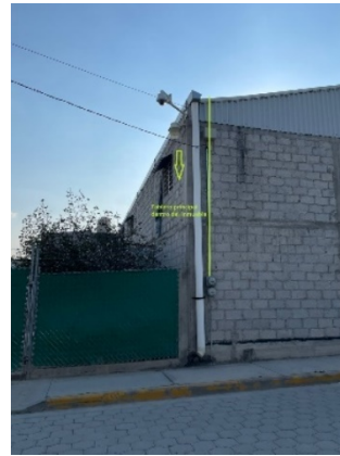
Imagen 10. Ubicación del tablero eléctrico
