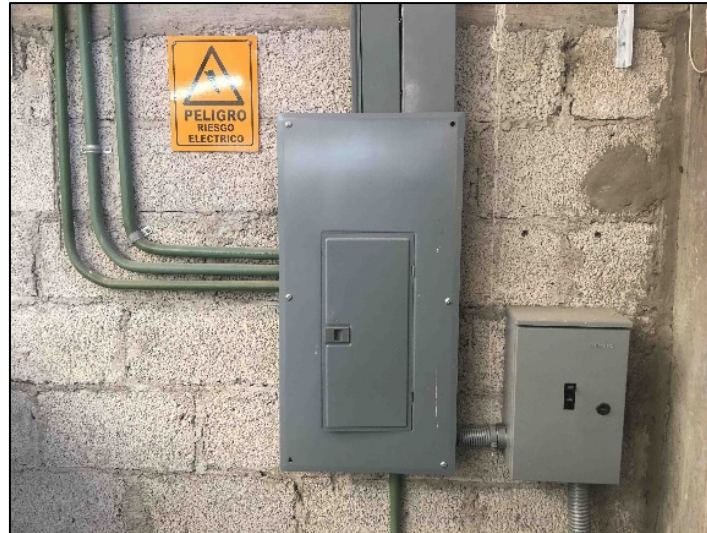
Figura 32 Tablero principal y de distribución
