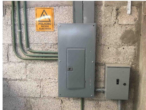
Ilustración 112. Tablero de distribución e interruptor termomagnético.
