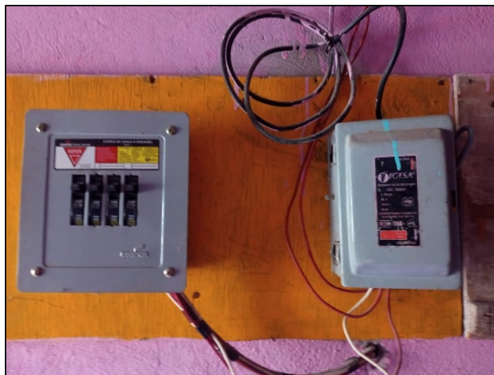
Figura 26 Del lado izquierdo está el Tablero de Distribución y del lado derecho esta la caja de fusibles
