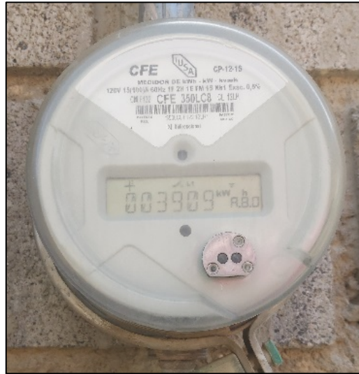
Figura 23 Medidor digital de CFE
