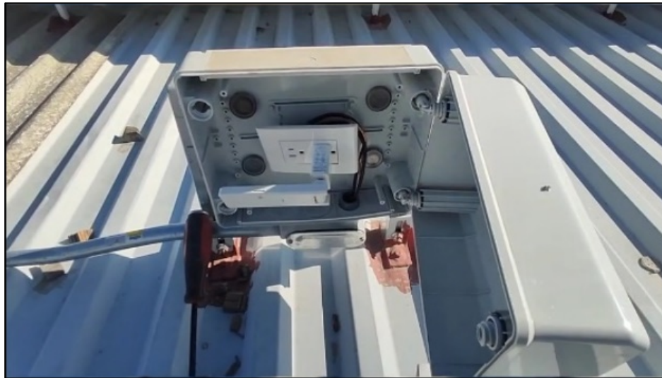
Figura 52 Conexión de DTU a microinversores
