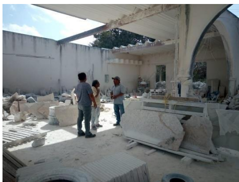
Figura 5.4 Estructura del edificio de la primera cooperativa de artesanos en la comunidad de Dzityá, Yucatán.
