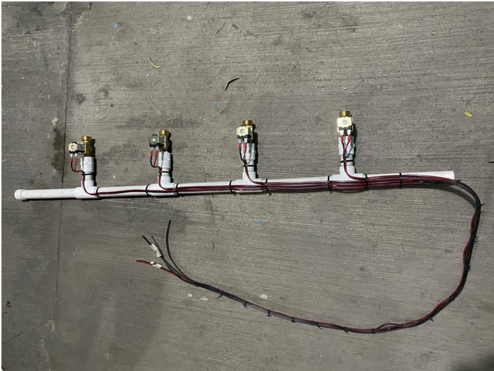
Figura 37 Sistema de electroválvulas y tubería
