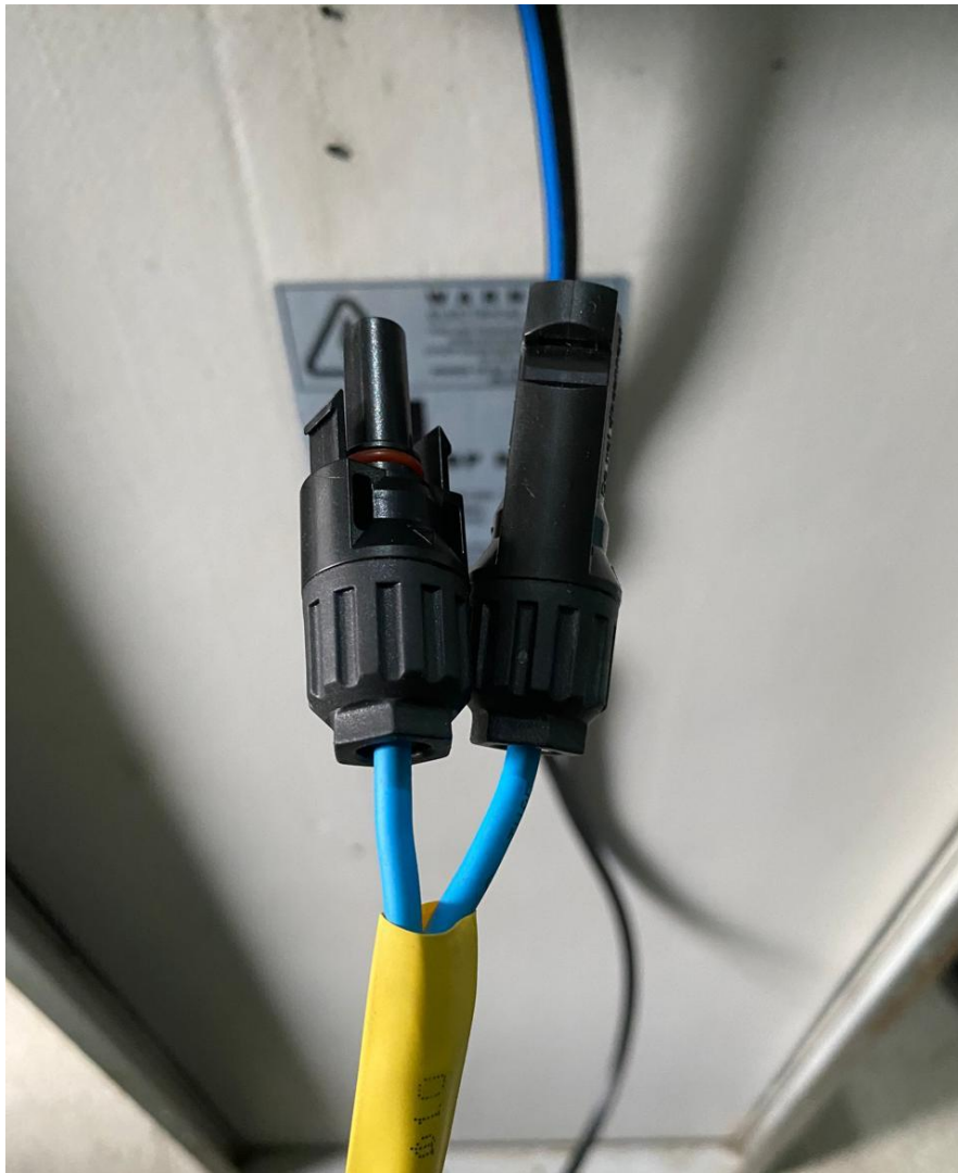
Figura 49 Conectores mc4 del panel fotovoltaico
