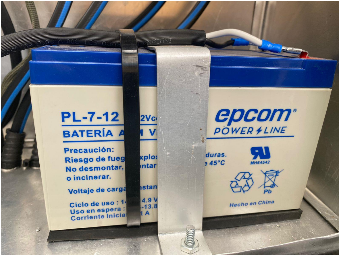
Figura 51 Anclaje de batería al gabinete
