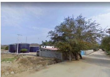
Figura 6. Planta tratadora de agua.
