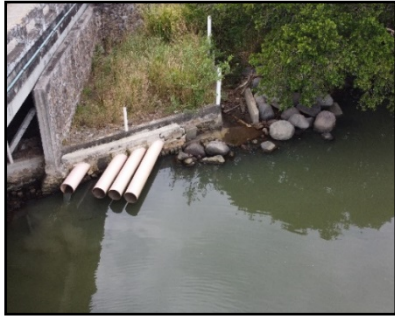
PUNTO 1 INICIO TUBERÍA RÍO JAMAPA
