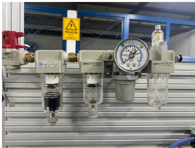
Unidad de mantenimiento
