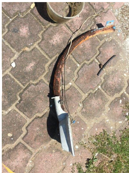
Imagen 18. Lámpara en deterioro.
