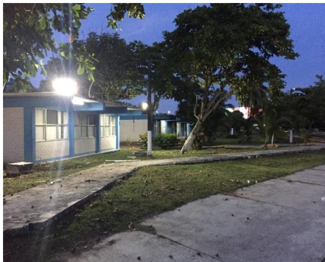
Imagen 23. Reflectores en funcionamiento en corredor.
