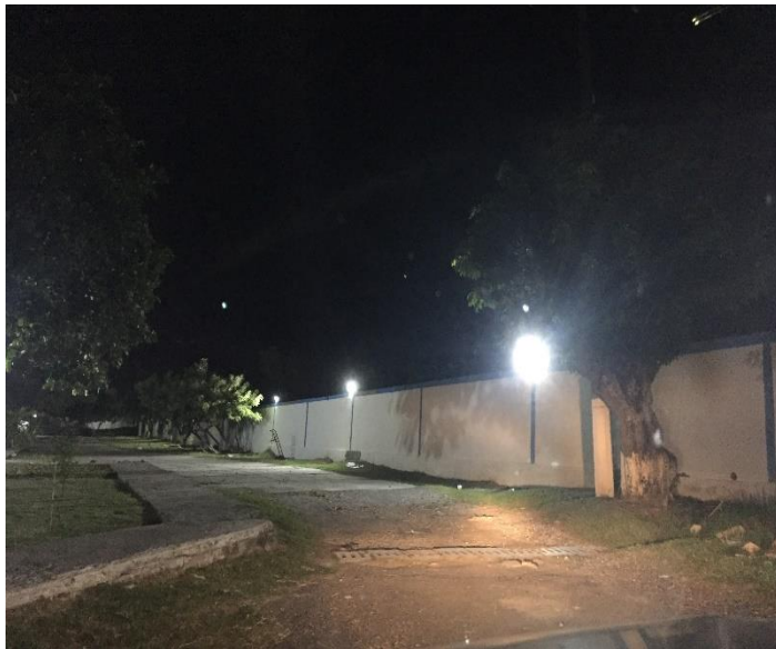
Imagen 24. Reflectores en funcionamiento barda perimetral.
