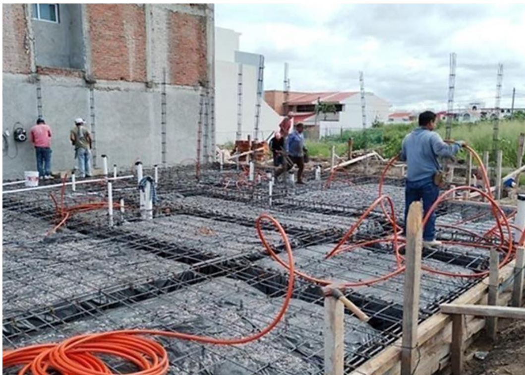
Fig. 4 Instalaciones hidráulicas de fontanería y eléctrica.
