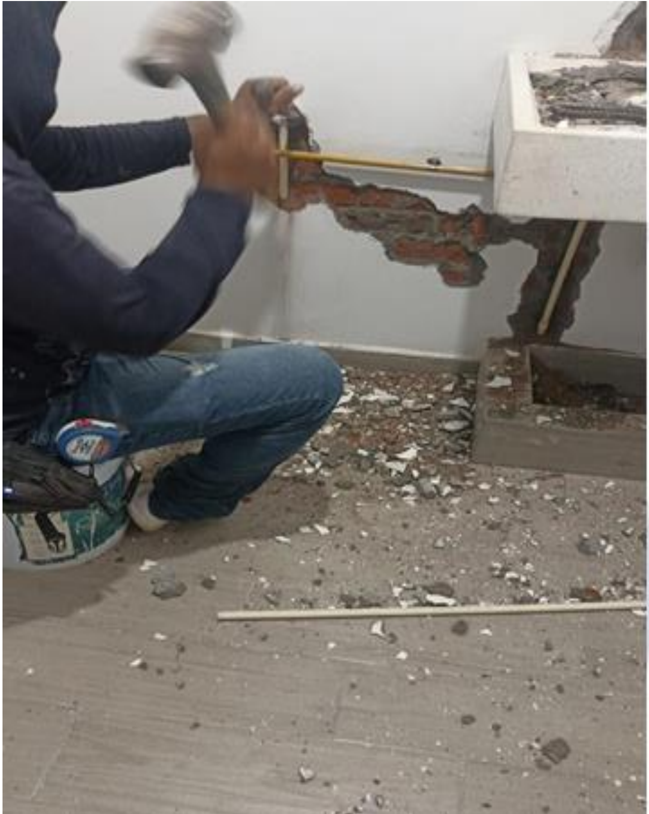
Figura 7. Destrucción en búsqueda de fuga de agua por nula supervisión en pruebas con barómetro.
