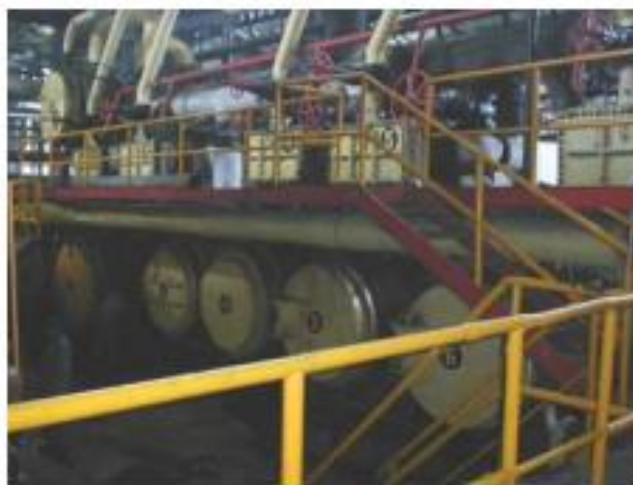
Figura 12. Calentadores utilizados en la etapa de clarificación.
