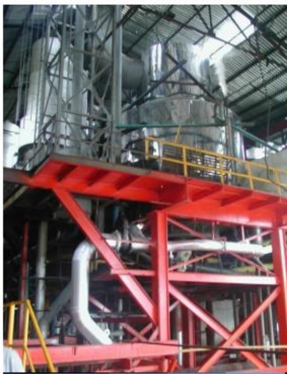
Figura 6. Evaporadores de múltiple efecto.
