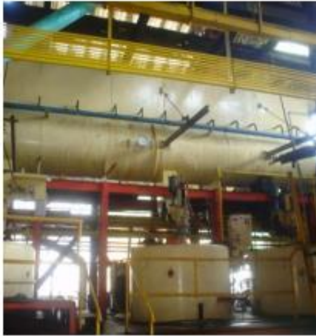
Figura 15. Equipo utilizado en la etapa de centrifugación.
