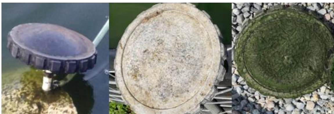
Figura 4.29 Diferentes estados de los discos difusores (De izquierda a derecha: con suciedad leve, desgastado y mohoso)
