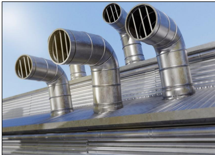
Figura 72: Tubos de ventilación con sistema de filtro
